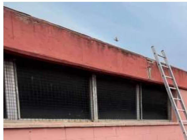
Cornisa superior coberta deteriorada.
