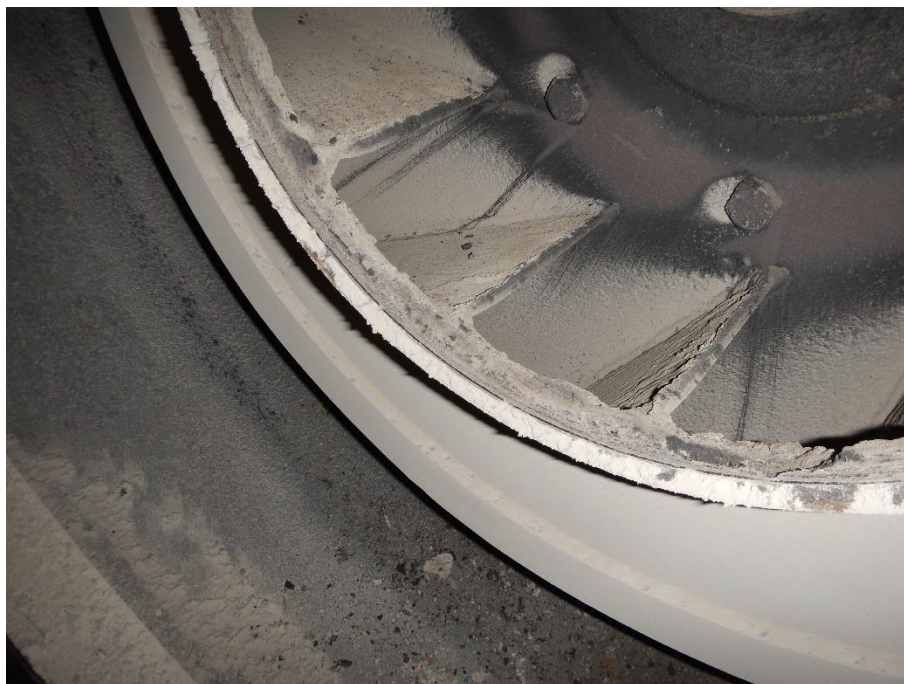
Ventilador de proceso V1030, recubrimiento de lodo sobre el rodete
