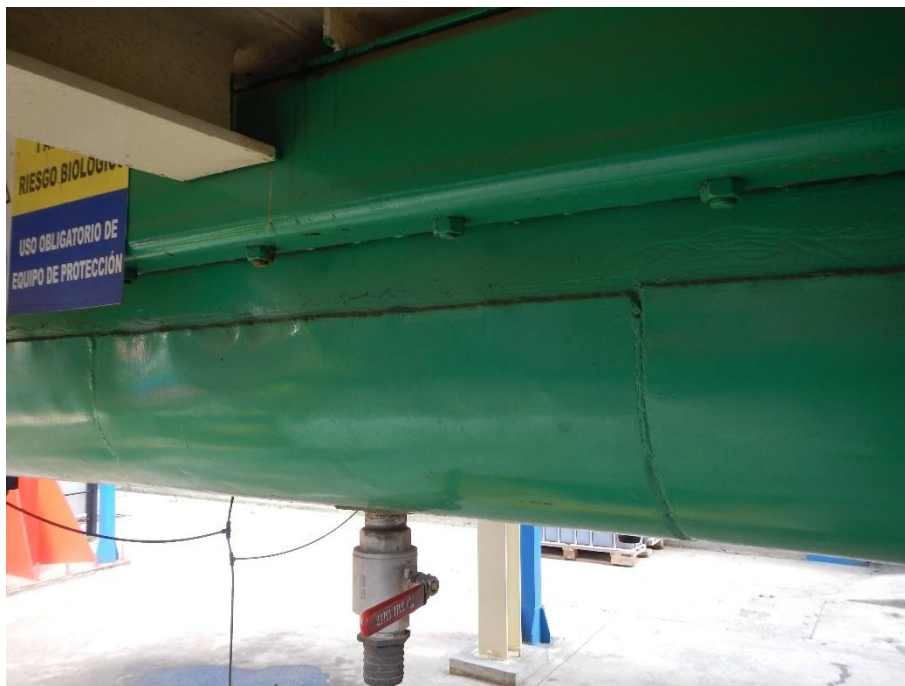
Silo B1710 bomba de lodos reparada con chapas soldadas
