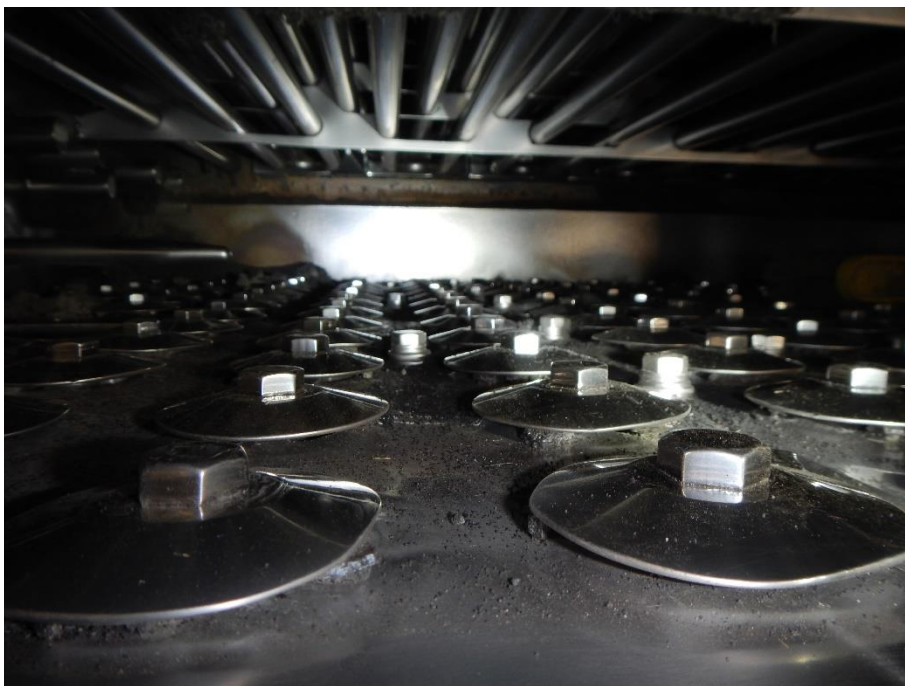
Placas de distribución, desgaste en los difusores
