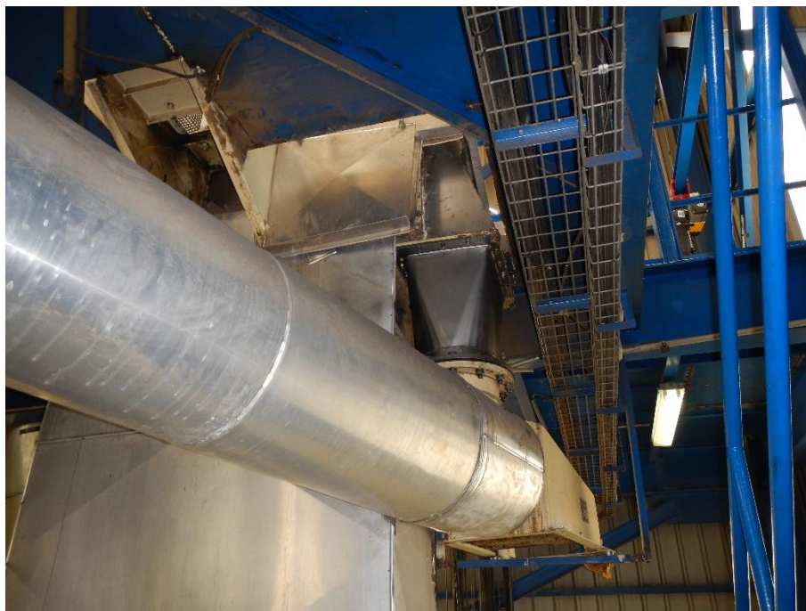
Transportador sinfin H1240, falta asilamiento en la entrada
