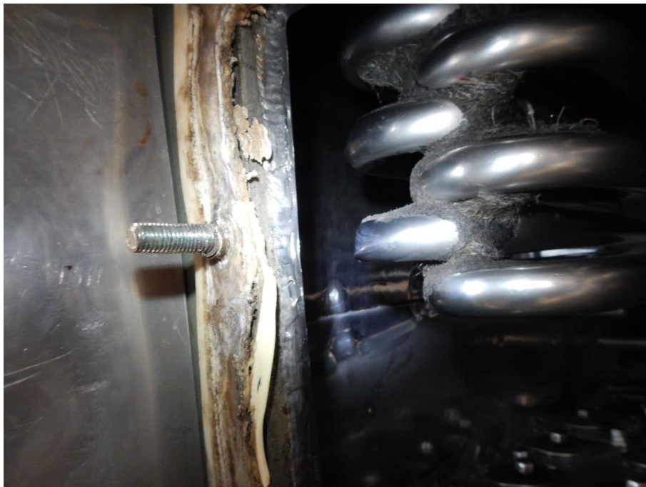
Desgaste en los tubos del intercambiador de calor
