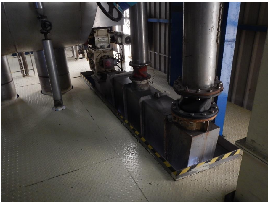
Compensadores aspiración campana enfriador del secador
