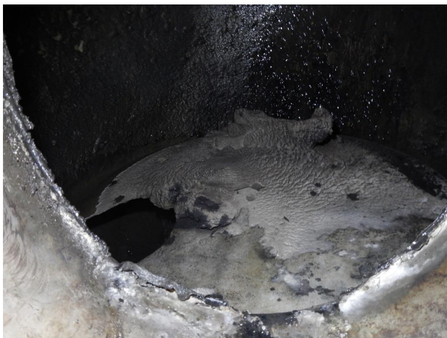
Separador F1175, depositos sobre la cubierta en el fondo
