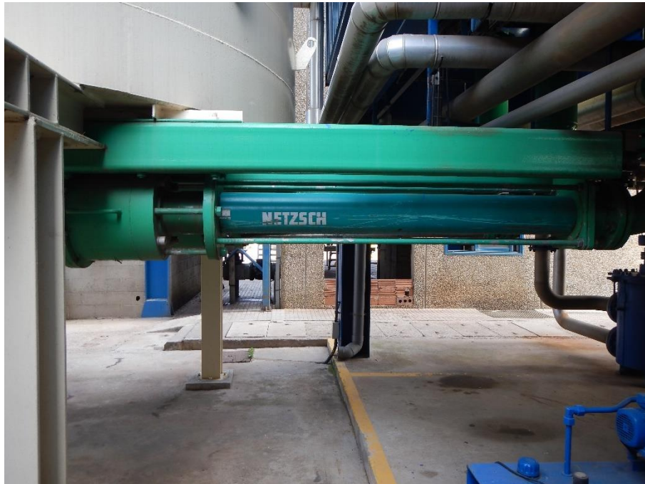
Silo B1710 con bomba de lodos
