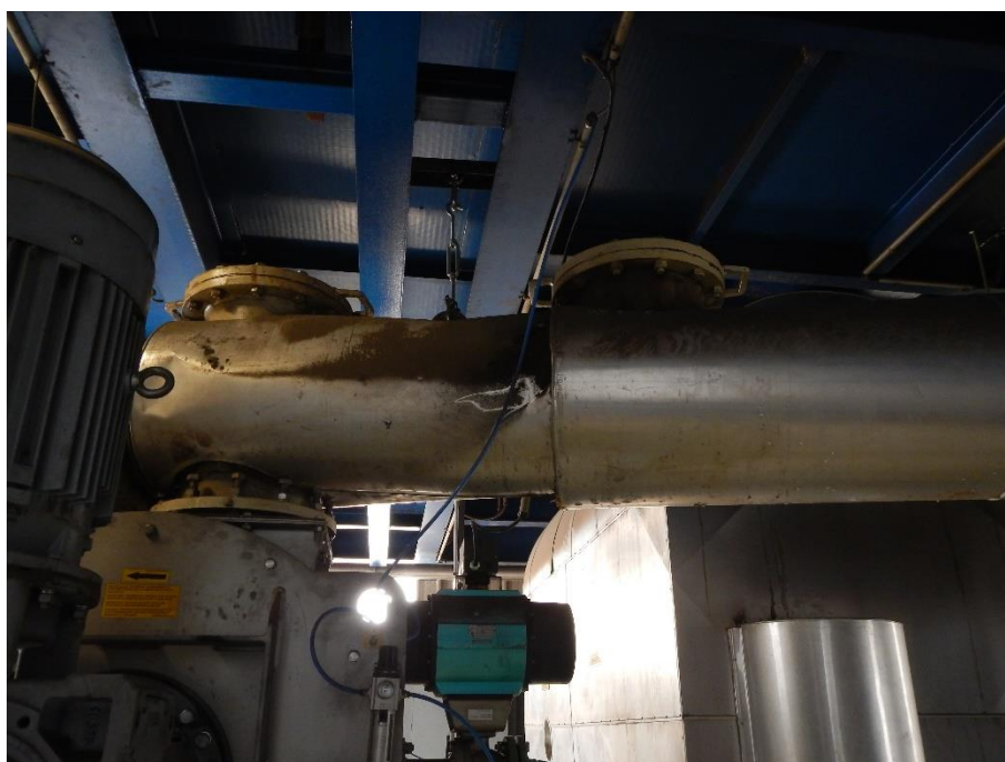
Transportador sinfín H1240, fuga de polvo a través del aislamiento
