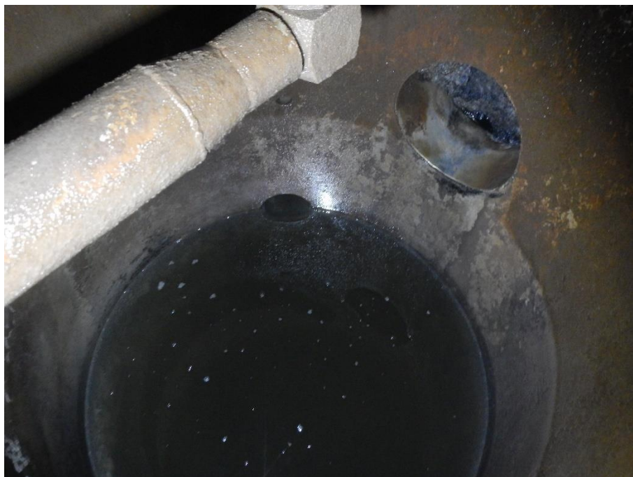
Lavador W1160, Depósito en la tubería de entrada de gas
