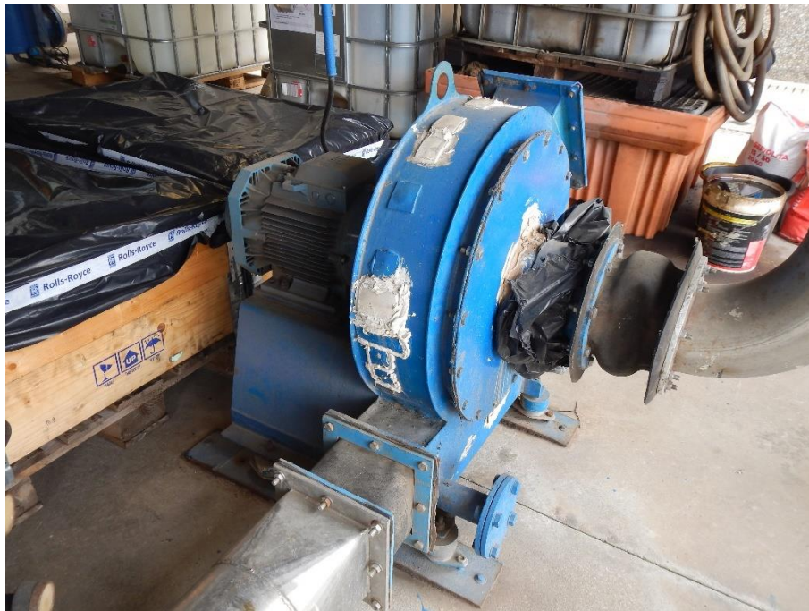
Ventilador V1140, refrigeración de producto, carcasa reparado
