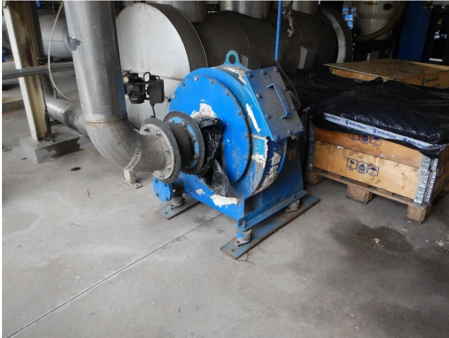
Ventilador V1140, refrigeración de producto
