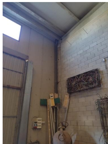
QUADRE ELÈCTRIC MAGATZEM
