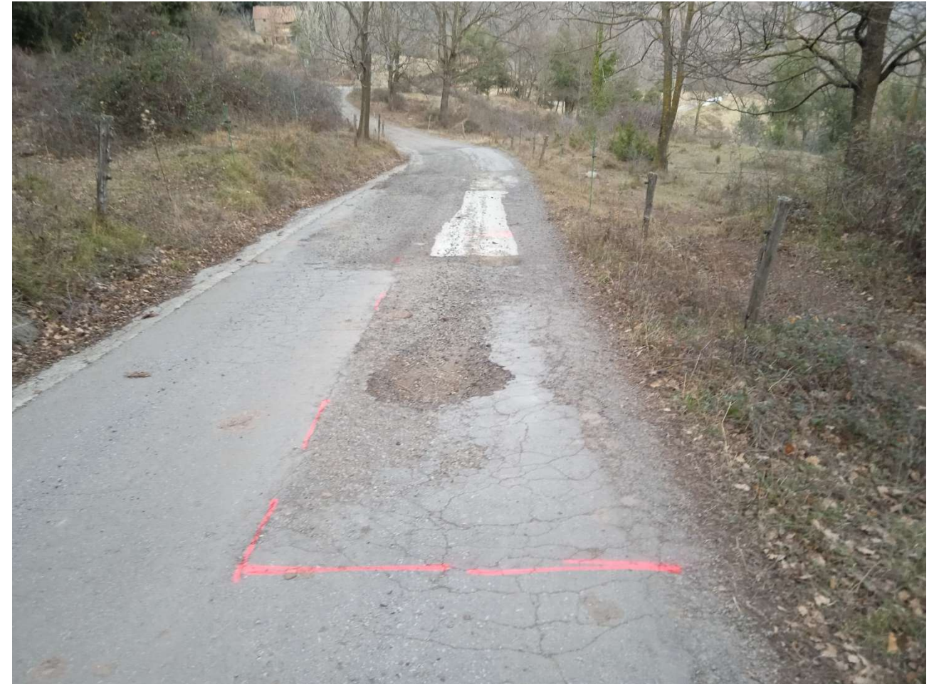
Foto 4. Vista del camí a l'alçada del PK 2+800. Correspon a un dels trams de més forta pendent de tot el recorregut. S'ha executat diverses actuacions de reparació de flonjalls, però apareixen nous forats just al costat de les superfícies reparades.
