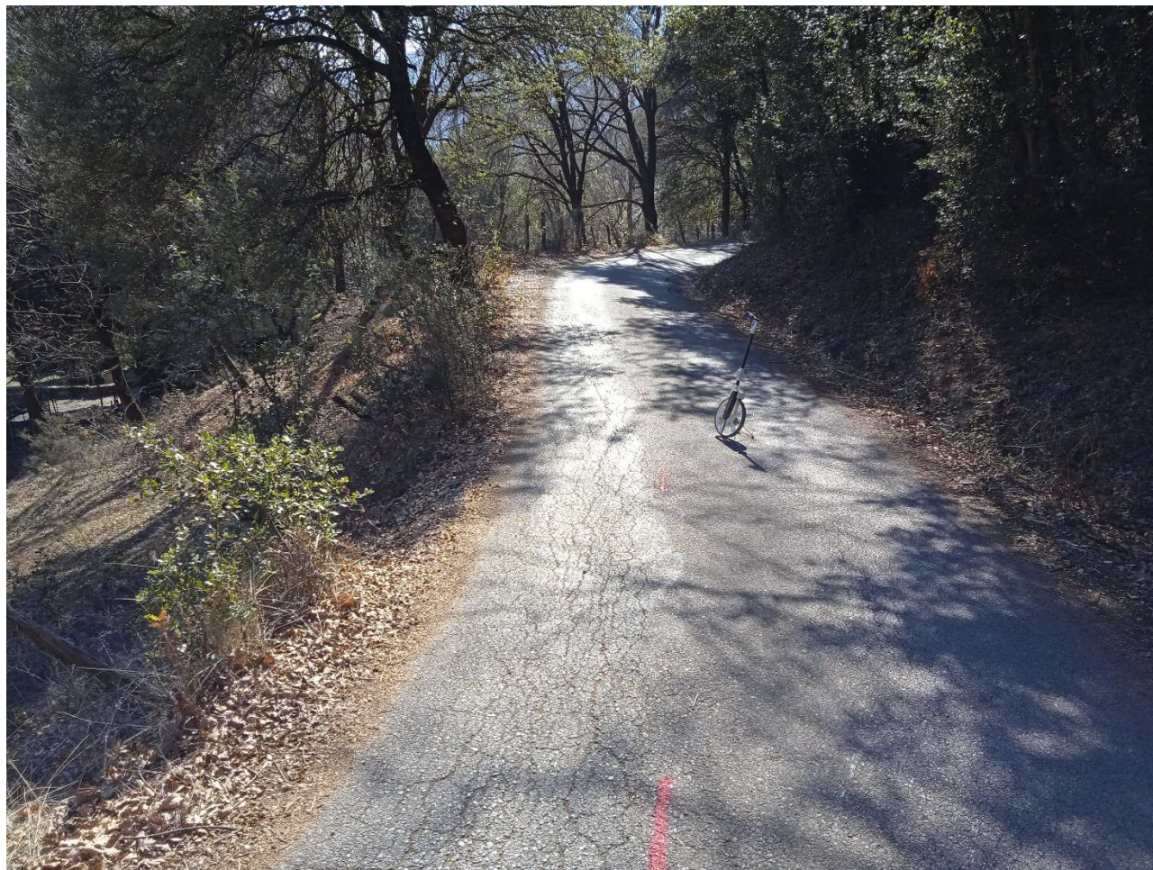
Foto 7. Tram que presenta un assentament important al MD de la calçada, amb abundant pell de cocodril. (PK 4+900 aprox) .
