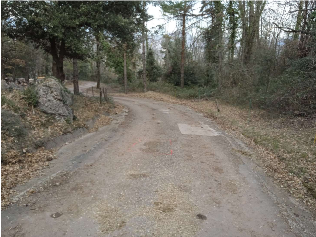
Foto 3. Tram que queda a prop d'un tancat de bestiar a l'alçada del PK 2+500. S'observa que s'ha realitzat algunes actuacions de reposició de flonjalls i la presència abundant de restes orgàniques sobre la calçada.
