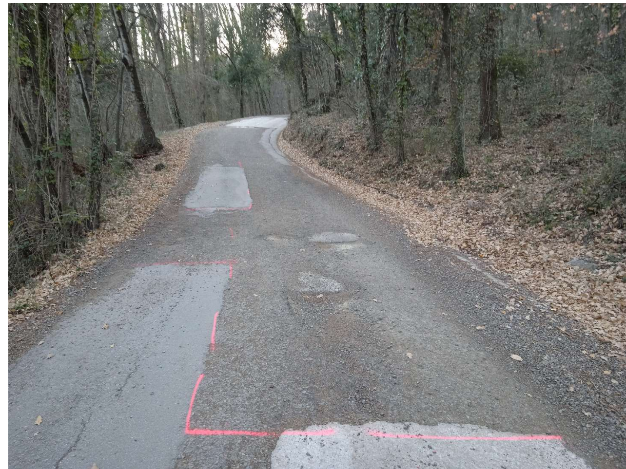
Foto 6. Punt del camí de Vidrà situat a la part baixa del TRAM 2. Presenta un gran nombre de forats i s'observa les actuacions de reposició de paviment realitzades.
