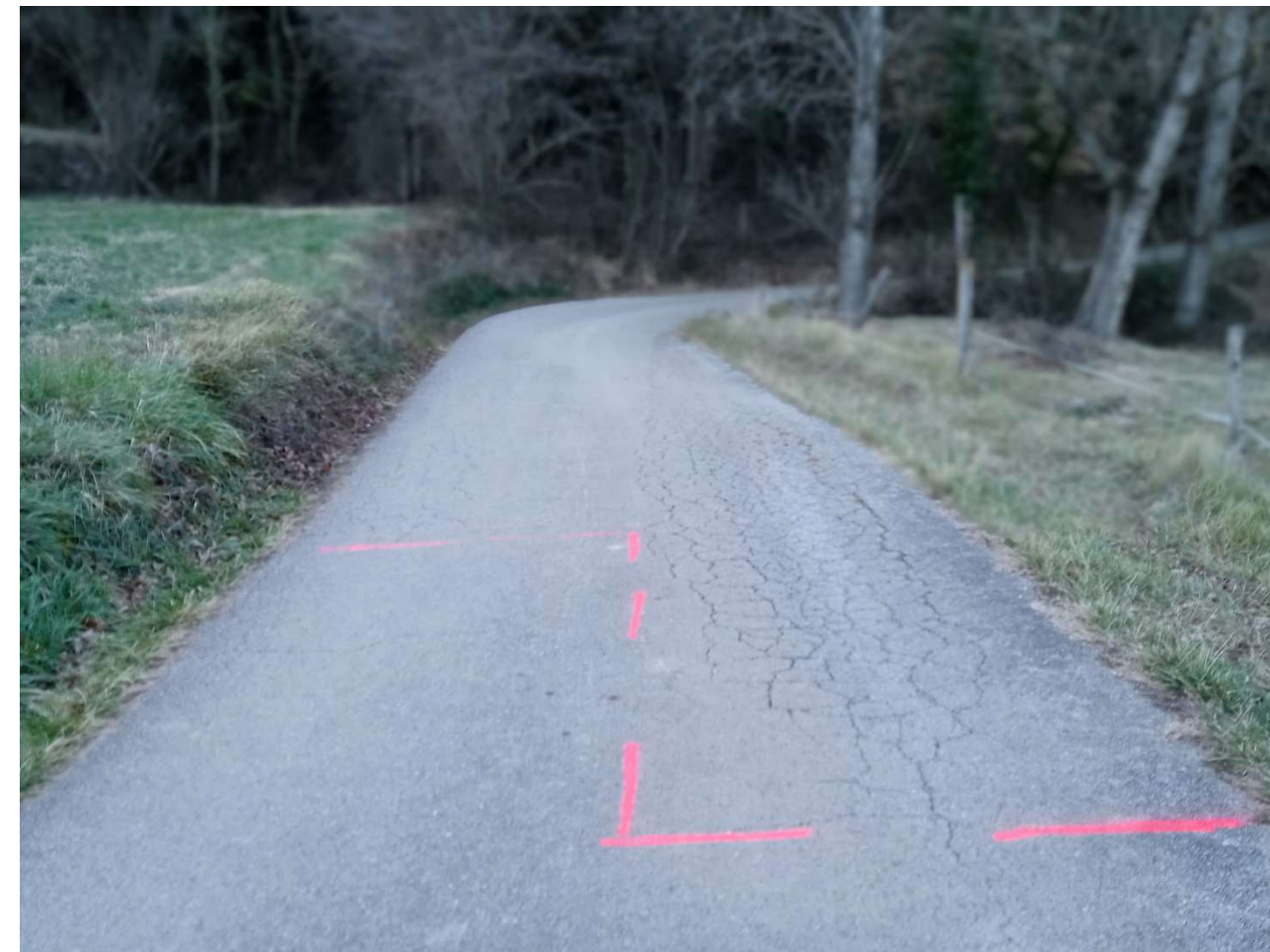
Foto 8. Tram ja situat un cop s'arriba a a la plana d'en Bas i que presenta assentaments importants i esquerdes. (PK 5+750 aprox) .
