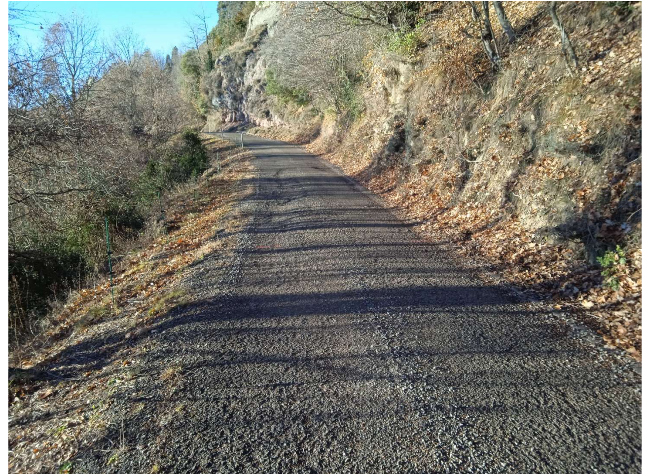
Foto 1. Estat del camí a prop del límit amb el terme de Vidrà. S'observa que la textura superficial del paviment és força rugosa i que en alguns trams l'àrid té tendència a desprendre's.
