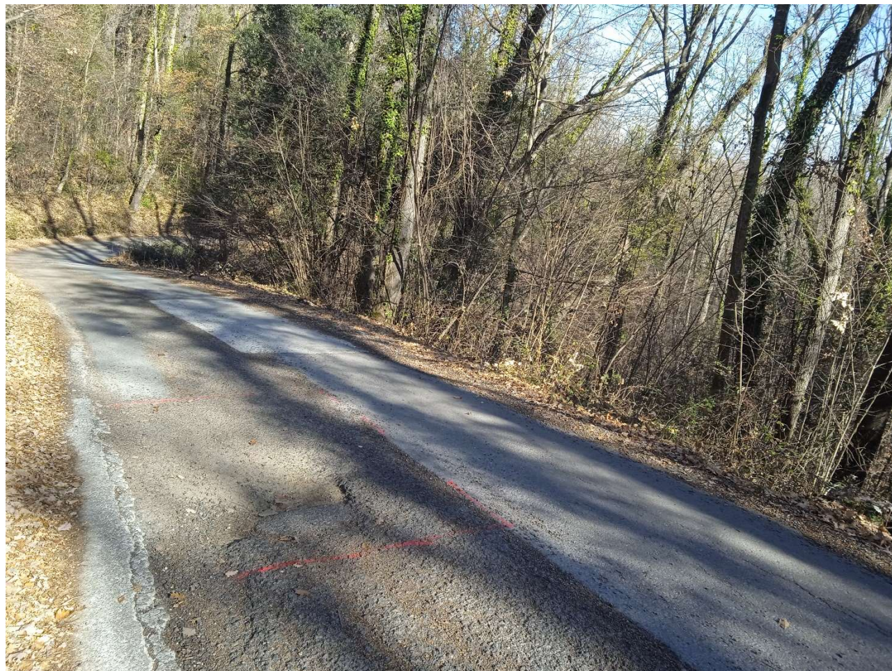
Foto 5. Punt on el camí de Vidrà ja s'endinsa dins el bosc de roures. Presenta un gran nombre de forats i superfícies relativament grans de paviment en què l'aglomerat ha saltat. S'ha executat diverses actuacions de reparació de flonjalls.
