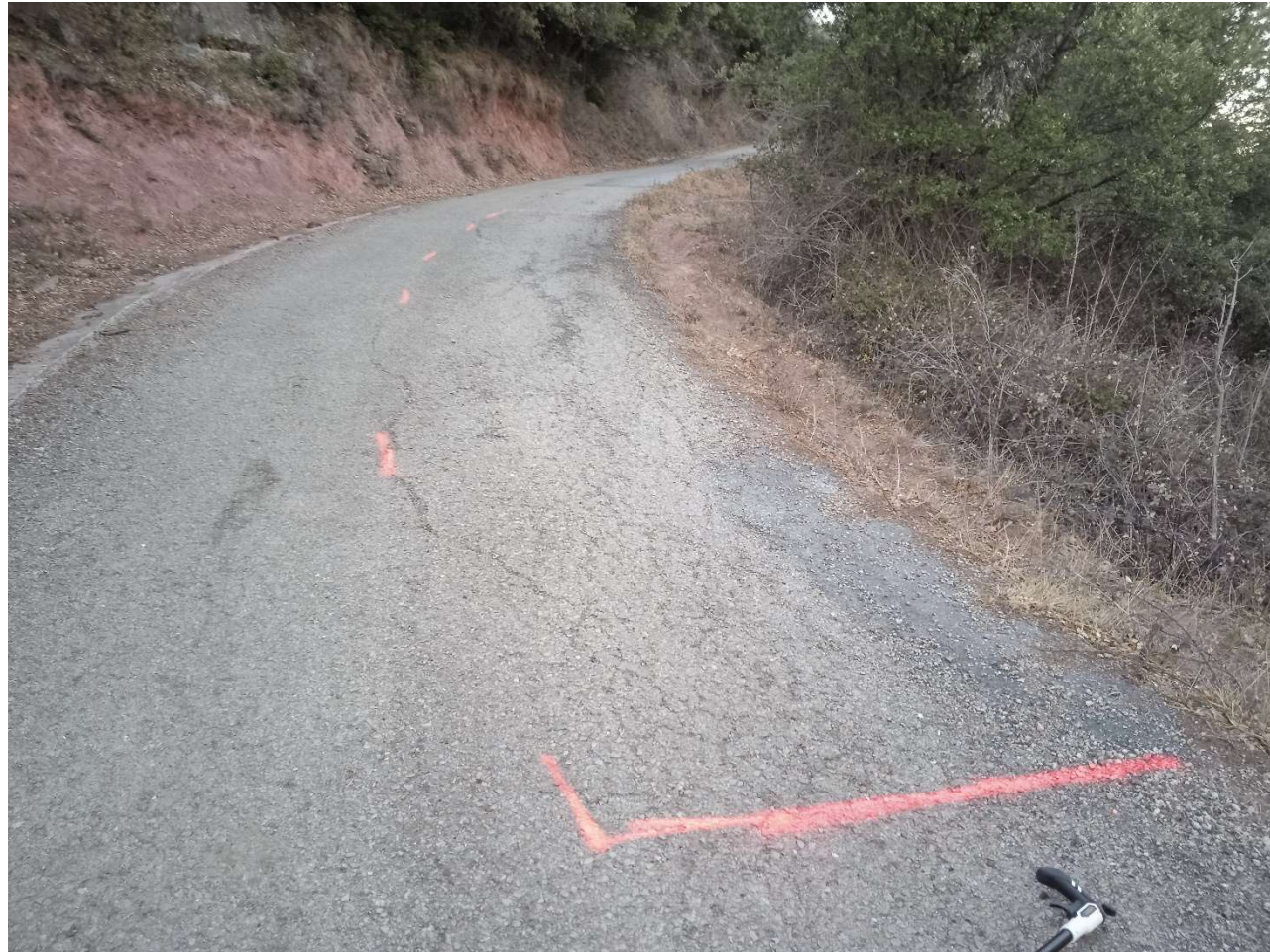
Foto 2. Revolt que presenta un assentament important al ME de la calçada. (PK 2+000 aprox) .
