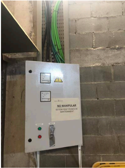
Quadre de protecció torres d'il·luminació
