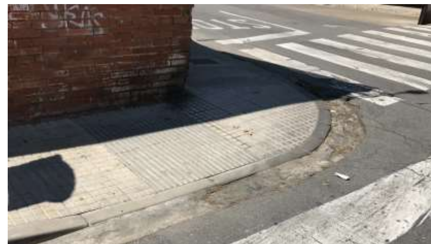
Foto 13: Estat actual cantonada a reparar
