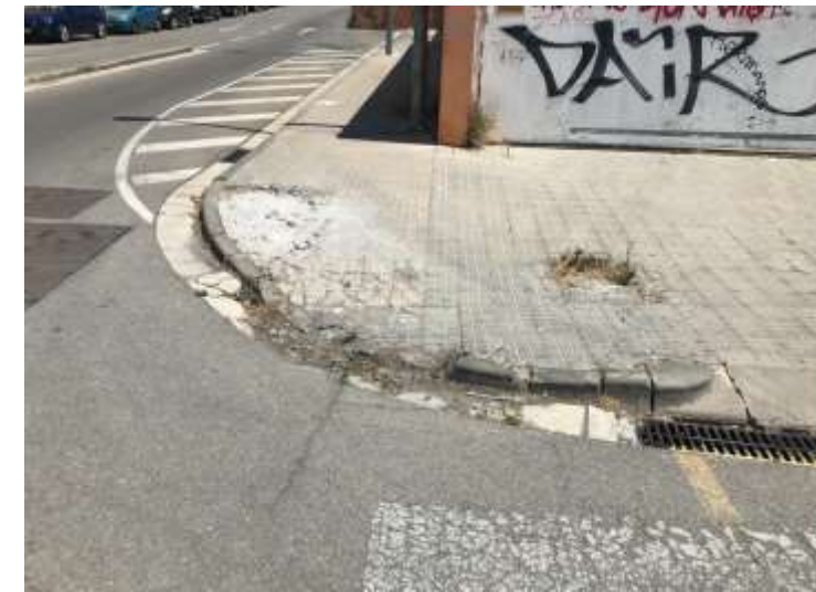
Foto 15: Cantonada Cadis ambAVINGUDA de les Flors a reparar
