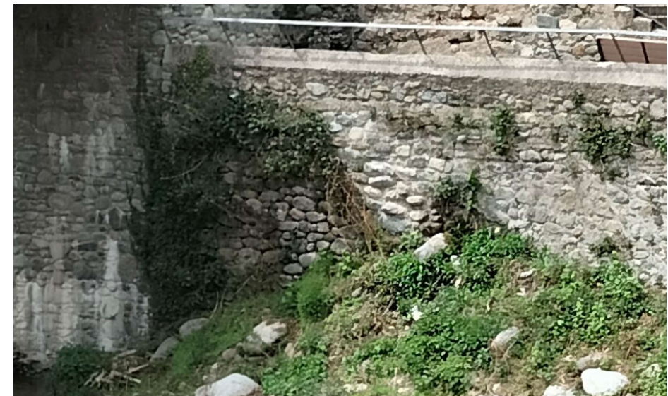
Falta de re-juntat: Mur de contenció plataforma inferior Passeig SEIDA
