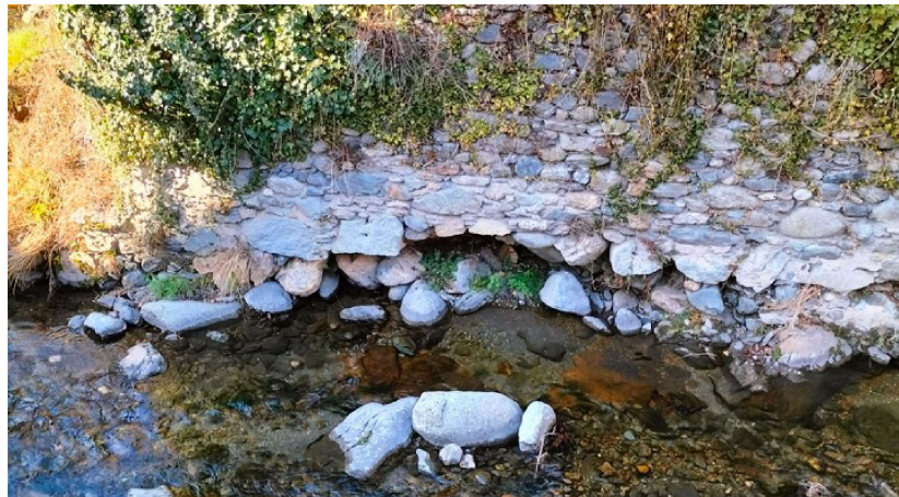
Socavament sever; afluent Segadell – Riu Freser
