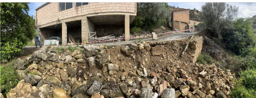
Mur de pedra seca col·lapsat
