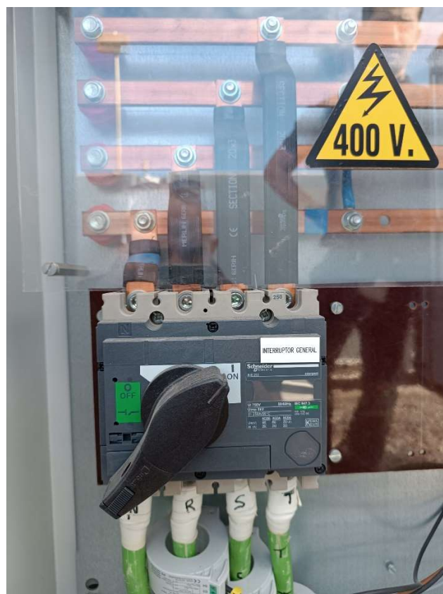
Fig. 27 Interruptor general del sub-quadre de connexió
