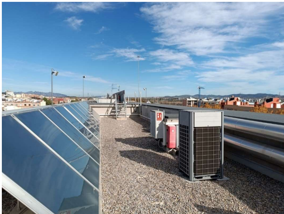
Fig. 24 Vista de zona de l'inversor i armari elèctric existent
