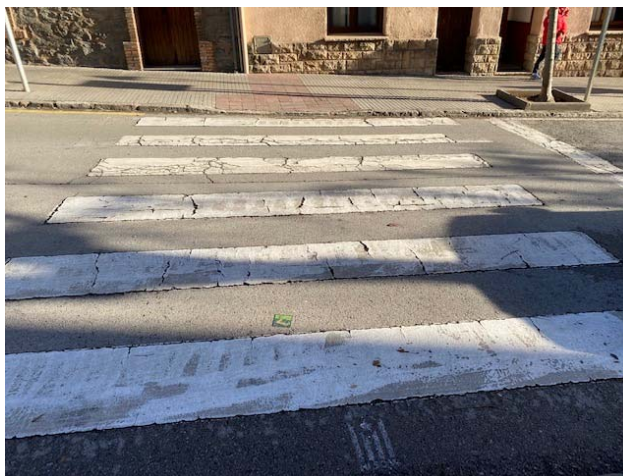
Vista al pas de vianants mal ubicat
