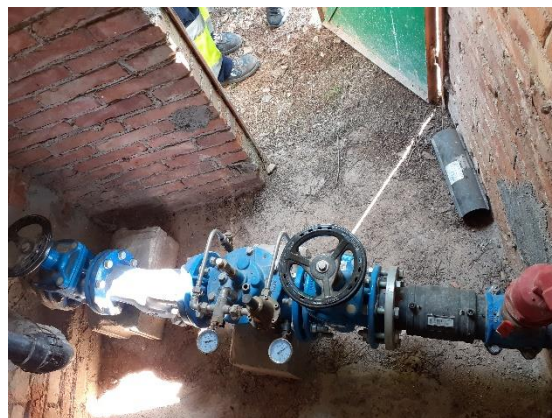
Figura 12: Vàlvules del dipòsit del Liri
