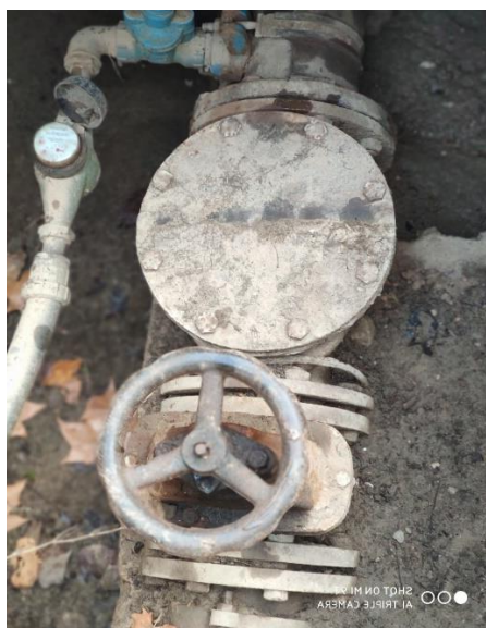
Figura 13: Interior connexió Sant Esteve Sesrovires
