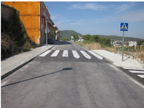
Pas de vianants elevat
