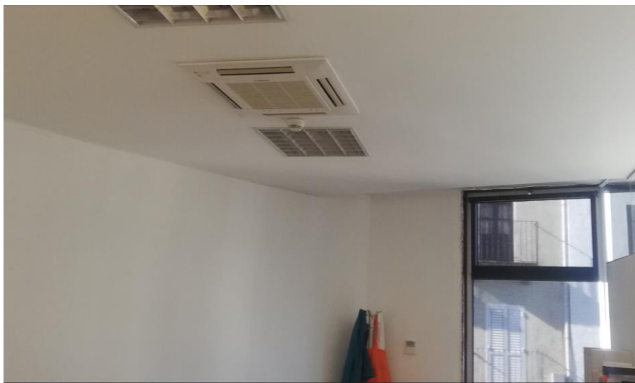
Despatx 2: màquines generals
