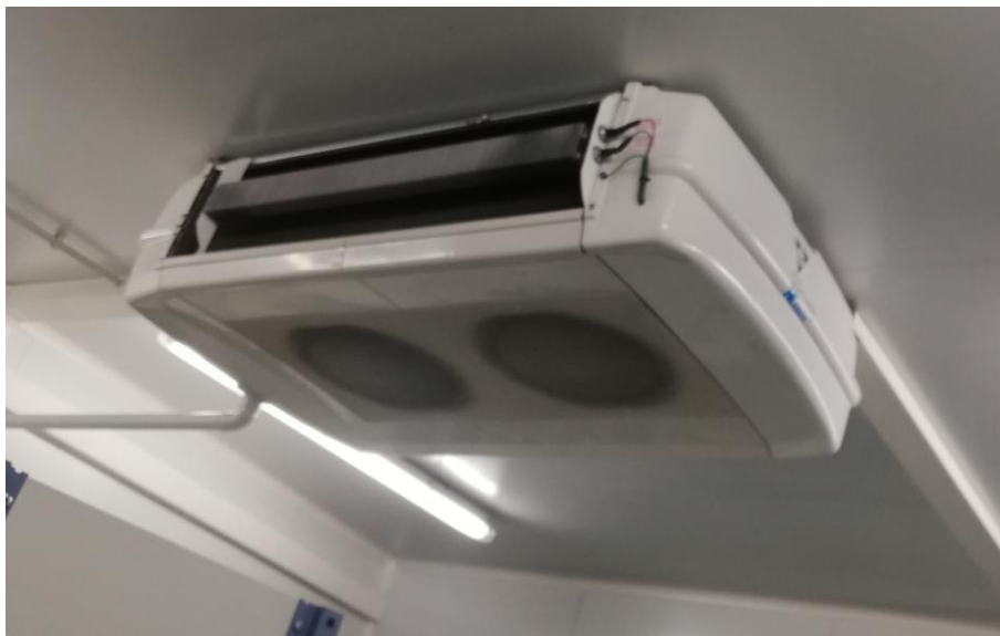
Suports especials: màquina de fred independent amb compressor a l'entrada PB
