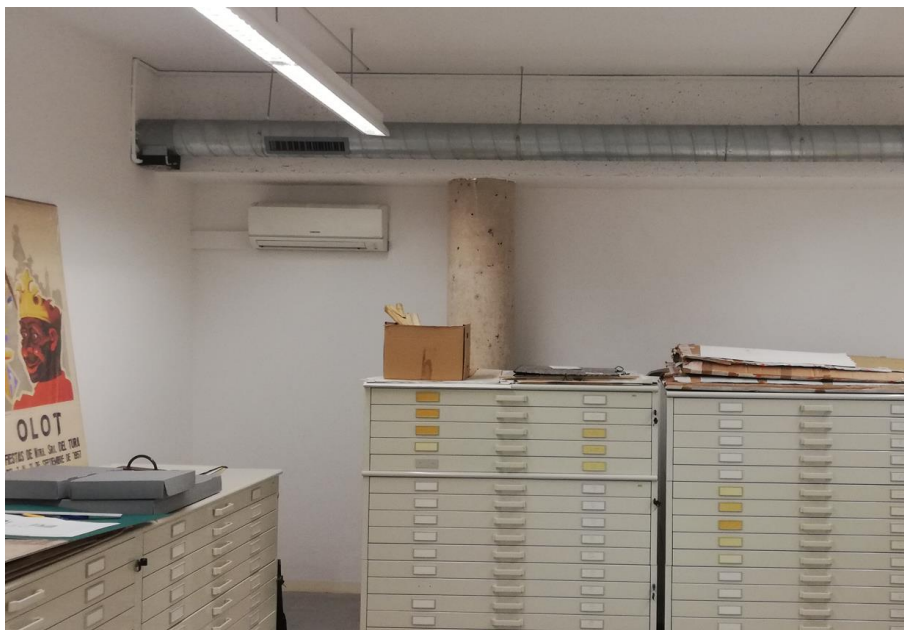
Sala grans formats: màquines generals
