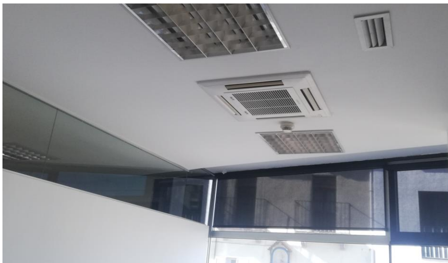
Despatx 1: màquines generals
