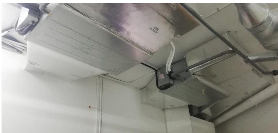
Sala polivalent: unitats interiors aparells de conductes 2 Ut, amb màquina exterior independent.
