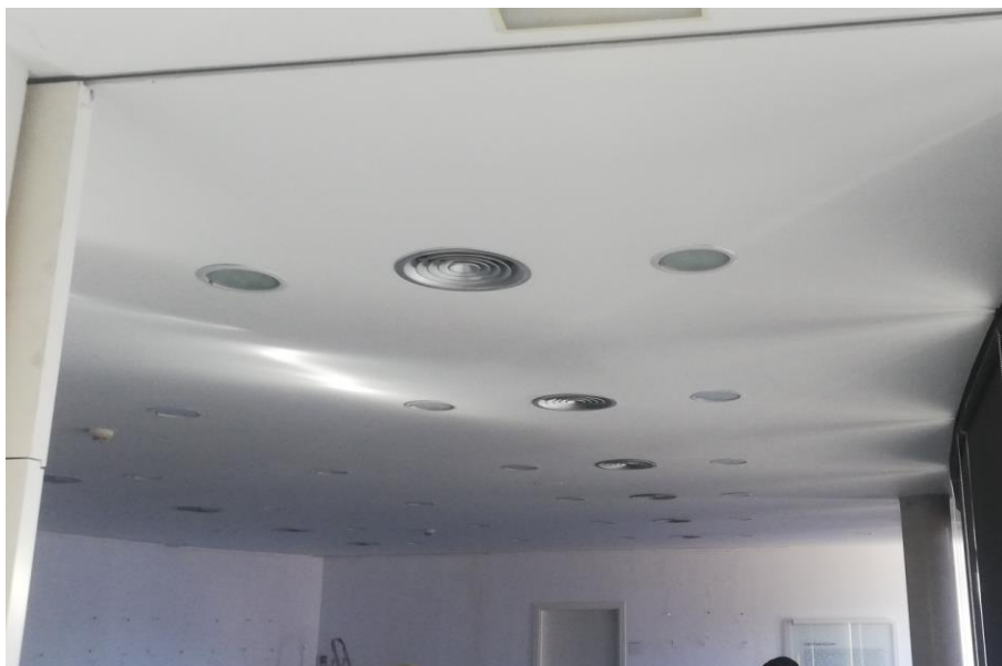
Sala polivalent: climatització per conductes
