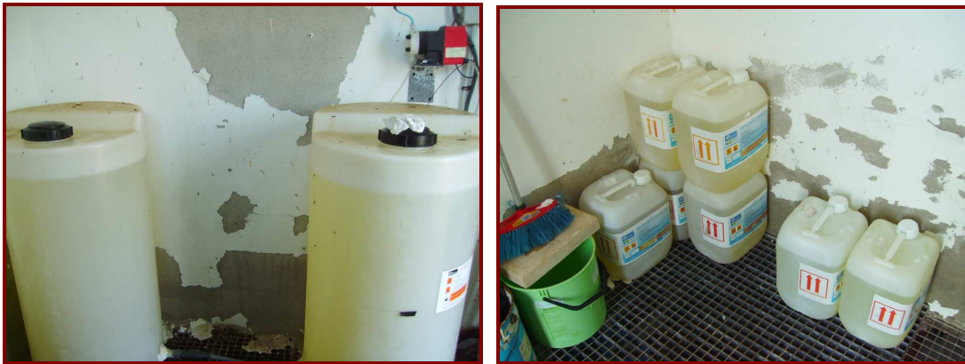
FIG 13. VISTA INTERIOR DE LA CASETA DE DESINFECCIÓ
