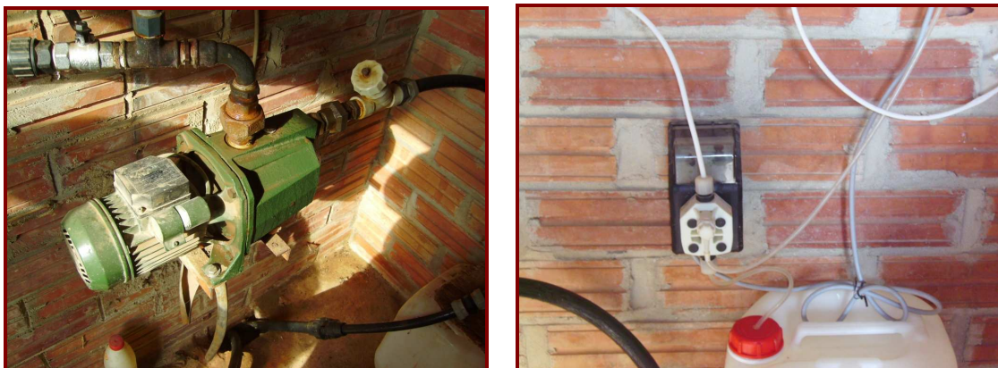
FIG 11. DETALL DE LA BOMBA DE RECIRCULACIÓ I LA D'INJECCIÓ DE CLOR
