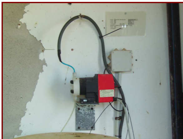
FIG 10. DETALL DE LA BOMBA D'INJECCIÓ DE CLOR
