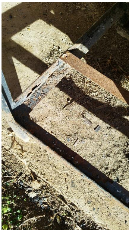
Estructura refredador aigua
