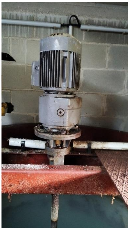
Motor en dipòsit preparació polielectròlit
