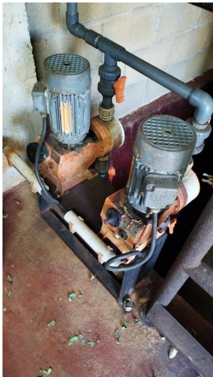
Bombes dosificadores clorur fèrric
