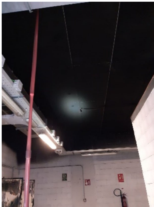
Sostre de la subcentral impregnat de sutge
