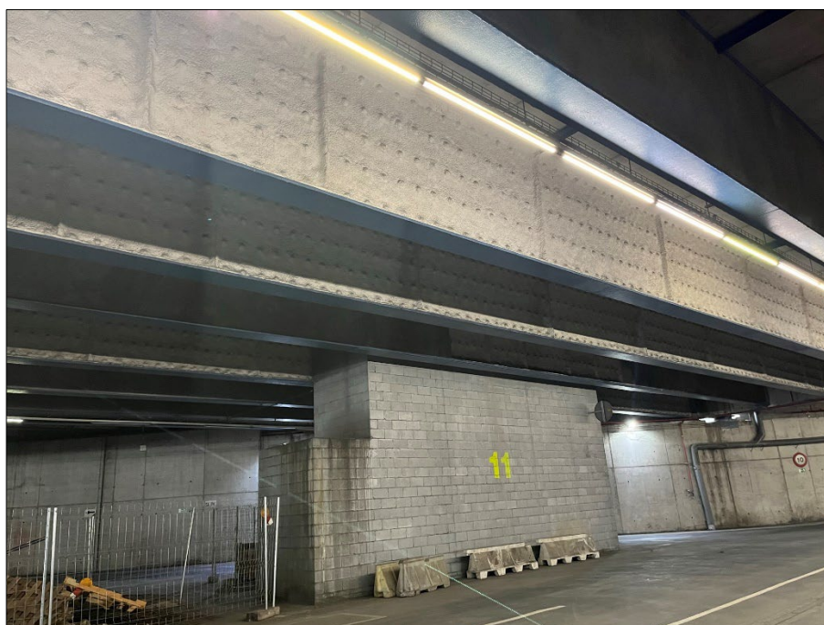
Fotografia 4. Vista inferior Llosa N+25.50
