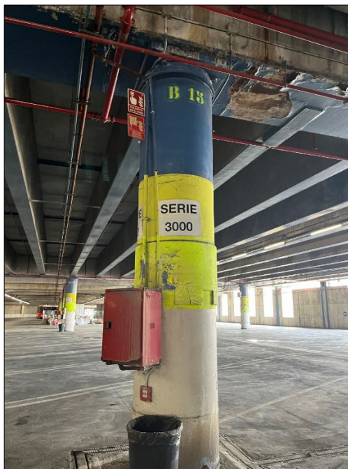
Fotografia 8. Vista inferior Llosa N+25.50
