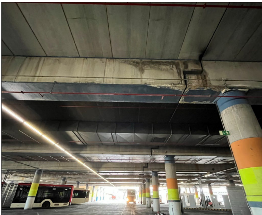
Fotografia 7. Vista inferior Llosa N+25.50
