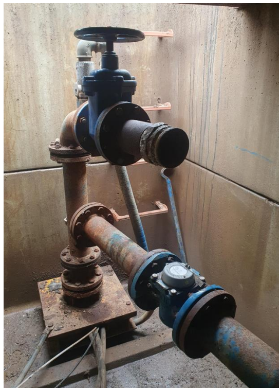
Il·lustració 2 Captació hidràulica interior arqueta
