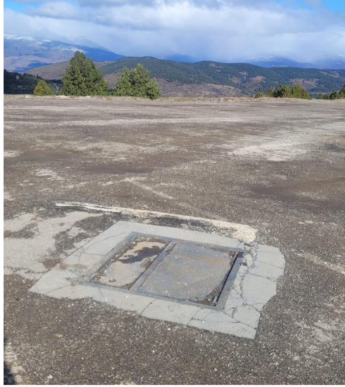
Il·lustració 1 Accés a la captació hidràulica a l'aparcament del Pedró
