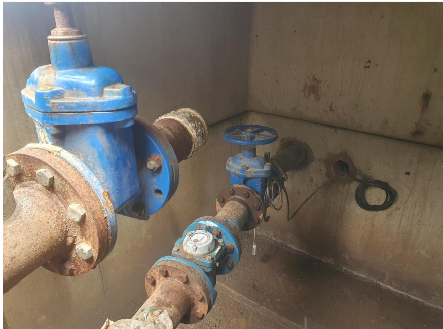
Il·lustració 3 Canonada d'impulsió hidràulica cap a bassa
