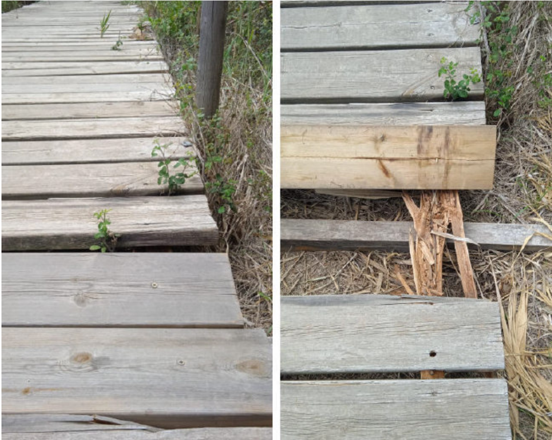
Figura 7: Aspecte actual de la passera amb els problemes estructurals
