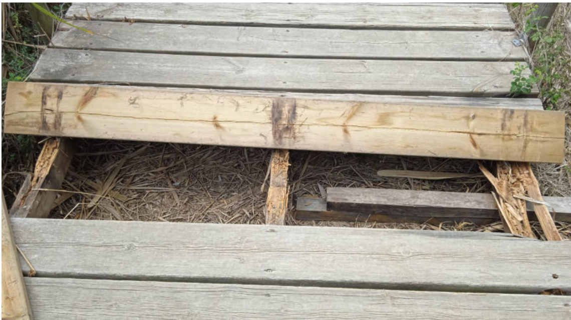
Figura 8: Detall del deteriorament de les bigues que suporten la passera en alguns trams
