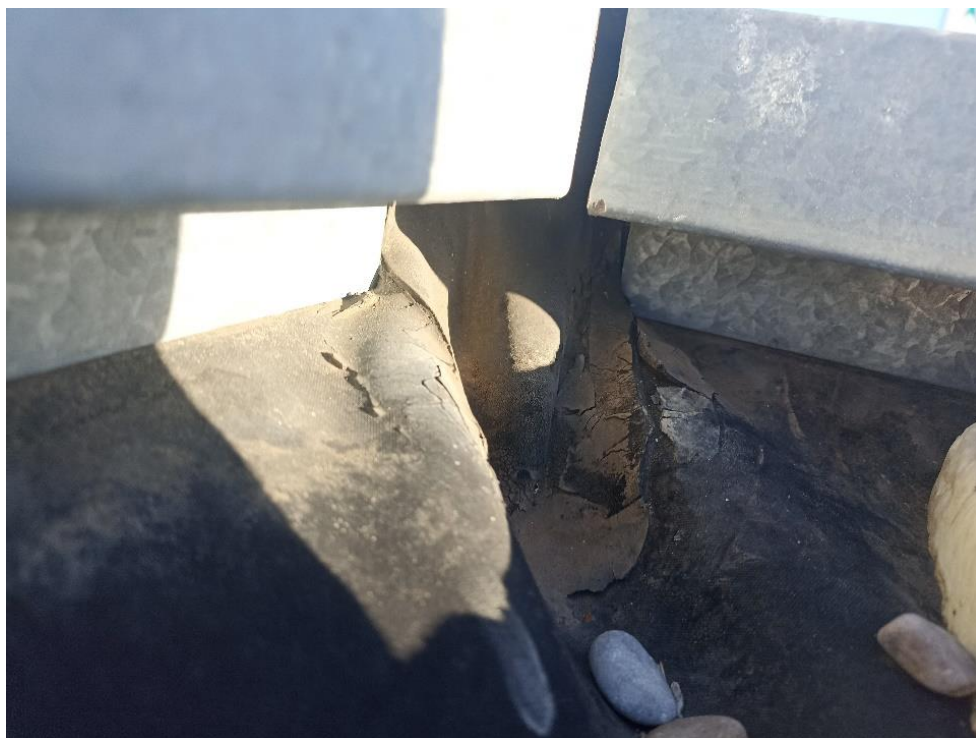
Fotografia P1.44 (Làmina impermeable en cantonada)
