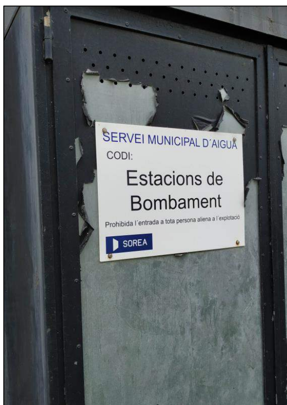
Figura 5: Placa de l'EDAR.
