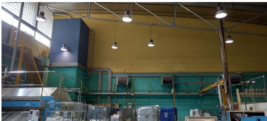
Imatge 1. Vista general de la zona de procés on s'observa que únicament hi ha producció de calor mitjançant aerotermos, i no es disposa de climatització de fred.
