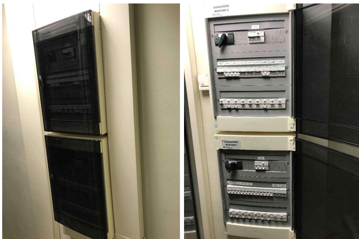
F18, F19. Fotografies sala rack, armaris SAI existents
