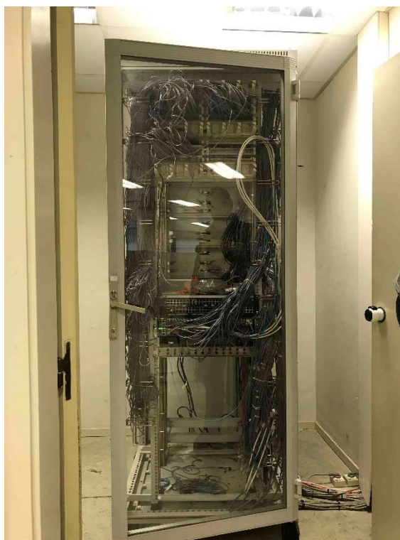
F17. Fotografia armari rack de dades existent
