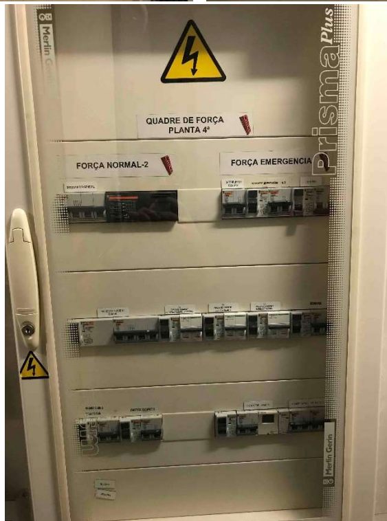
F14, F15, F16. Fotografies de la Sala de quadre elèctrics de força general existents
