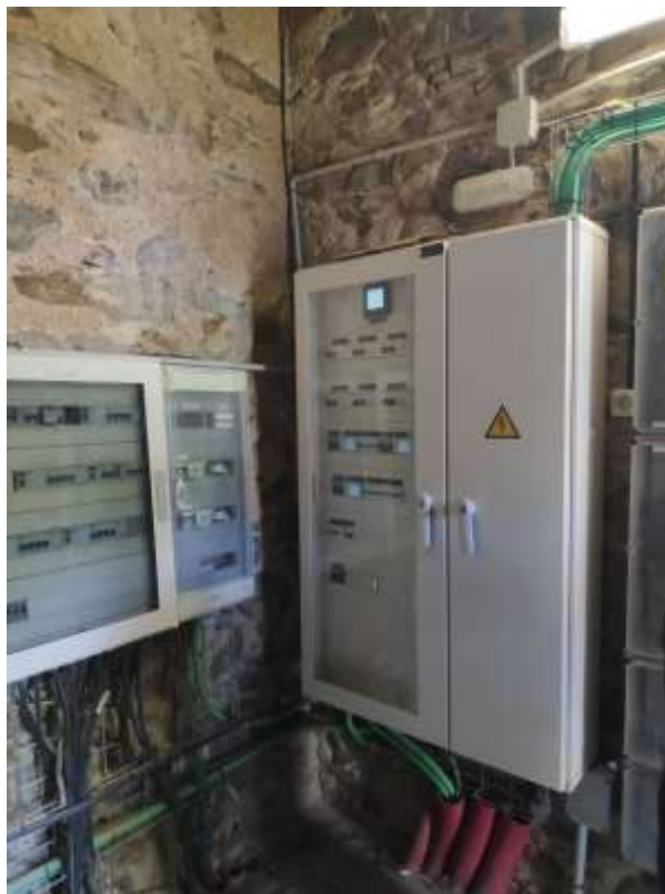
F7 F8 i F9. Vistes de la sala d'instal·lacions
