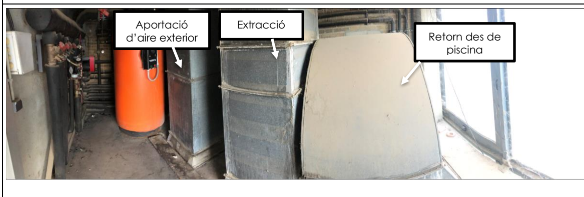
Estat actual: Acumulador ACS i conductes extracció/aportació d'aire
