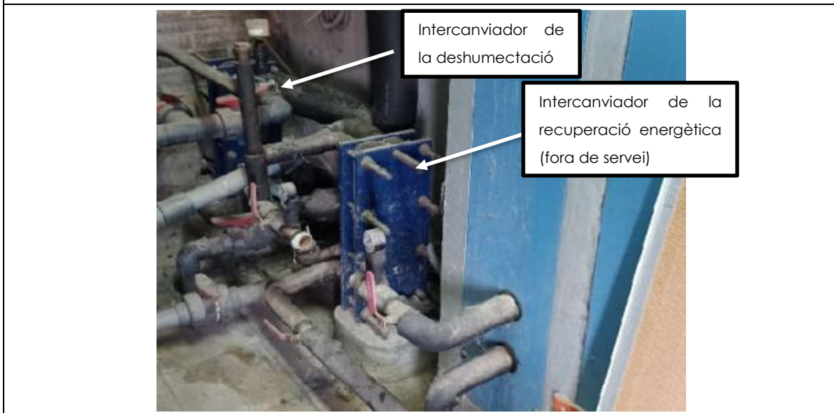
Estat actual: Intercanviadors de plaques.
