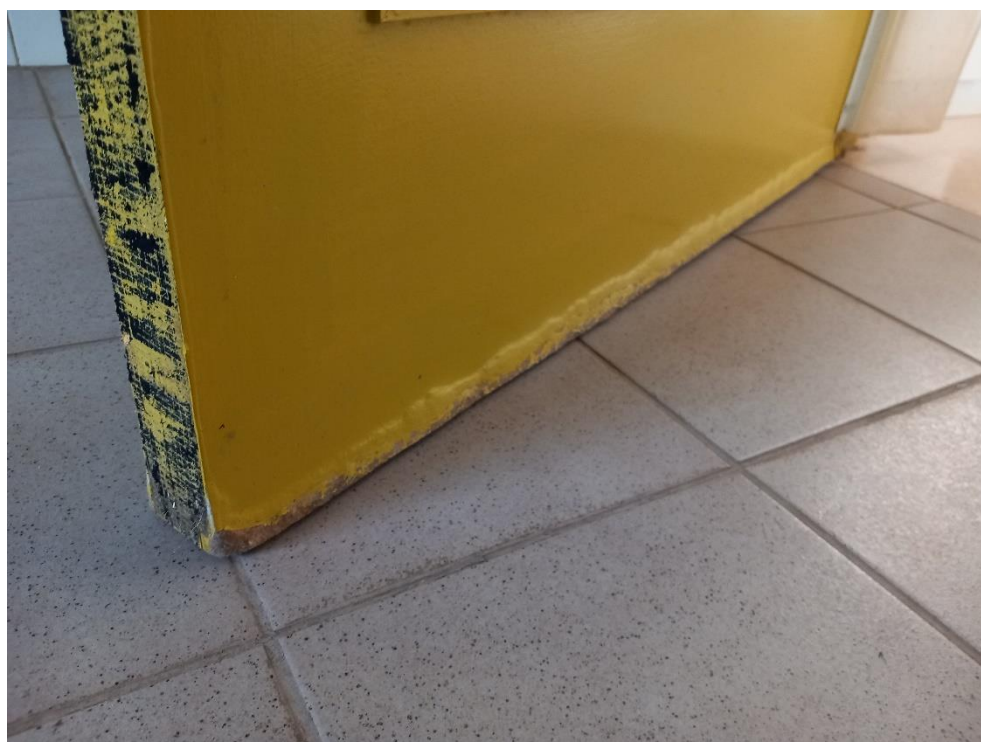
Estat de les portes
