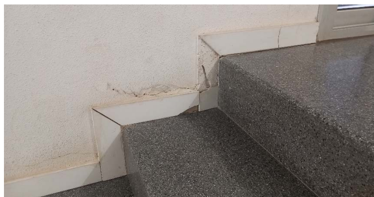
Fotografia 11: Detall Esclaons deteriorats
