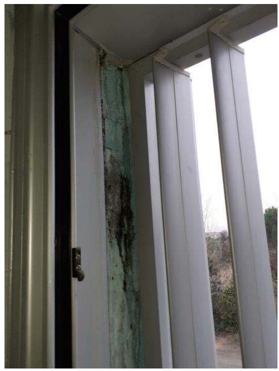
Filtracions en l'edifici de primària.
