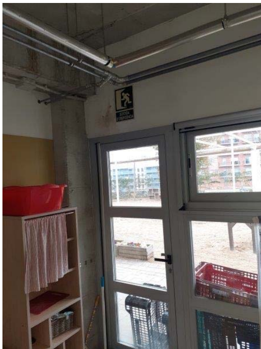
Filtracions en edifici infantil (aula)
