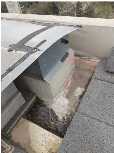
Degradació en entregues entre paraments, amb múltiples reparacions.
