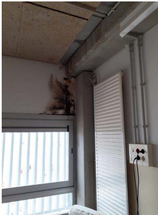
Filtracions entre elements estructurals i de tancament.
