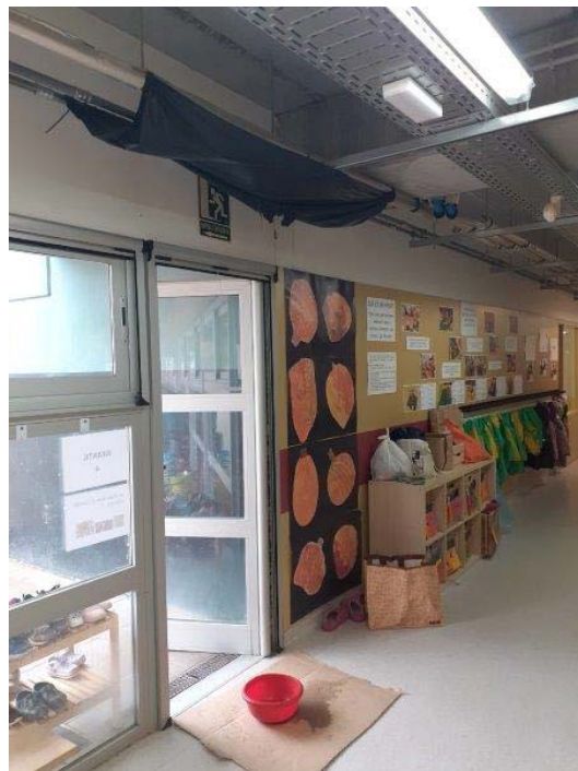
Filtracions en edifici infantil (passadís)
