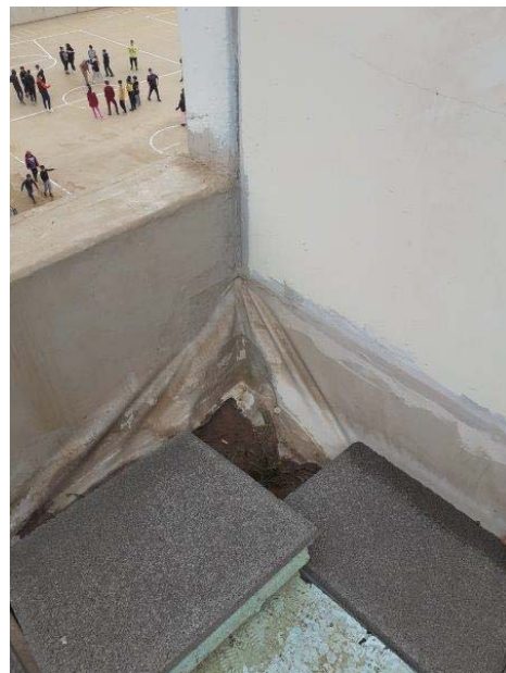
Degradació en entregues entre paraments, amb múltiples reparacions i tensions en les cantonades.
