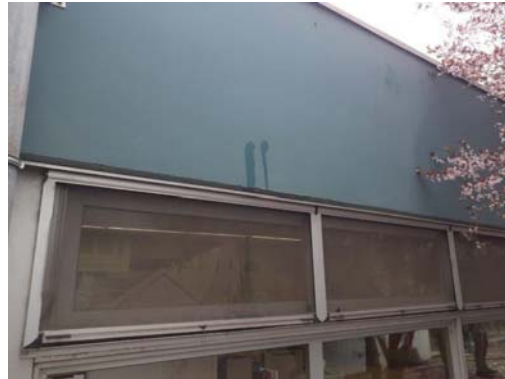
Detall exterior fusteries amb filtracions.
