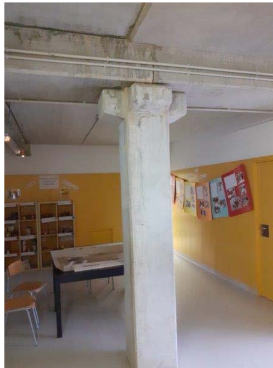
Distribució de les filtracions pels elements de l'estructura a l'interior de l'edifici.
