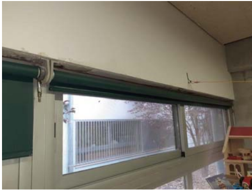
Humitats per filtracions en zona superior de fusteries, edifici infantil.
