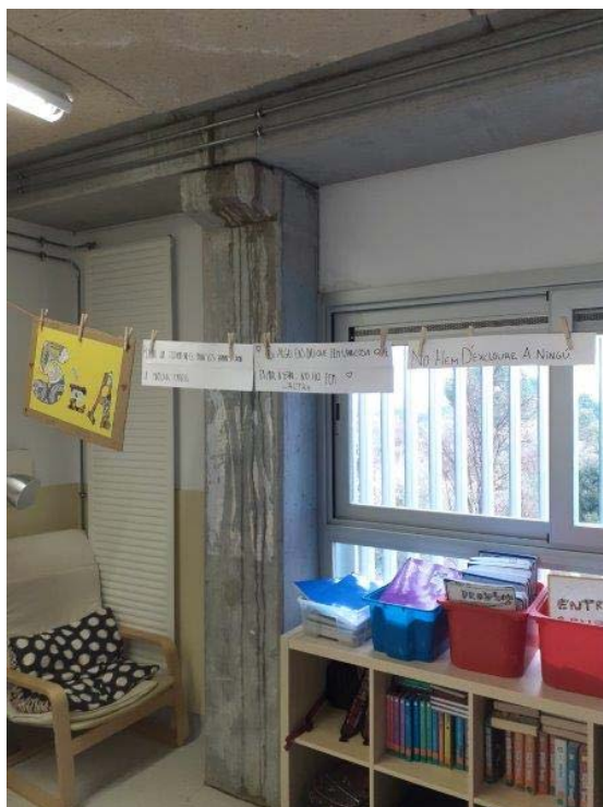
Filtracions en l'edifici de primària.
