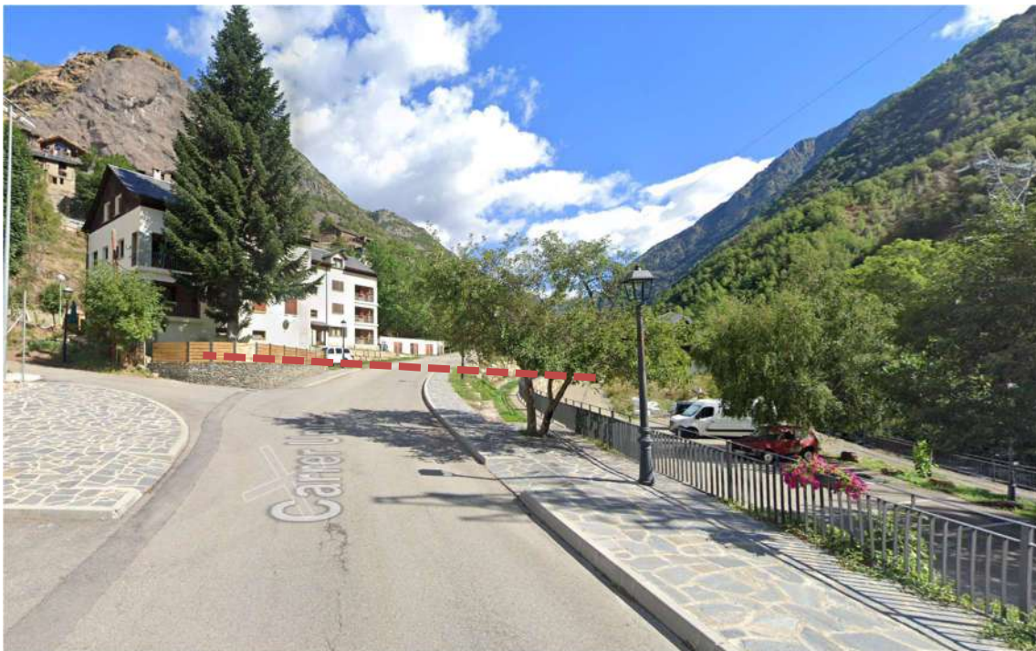
Imatge 9: Darrer tram pavimentat a Tavascan. A partir de la marca indicada no hi ha paviment que diferenciï clarament entre la calçada i la vorera que porta fins a l'entrada a la central.
