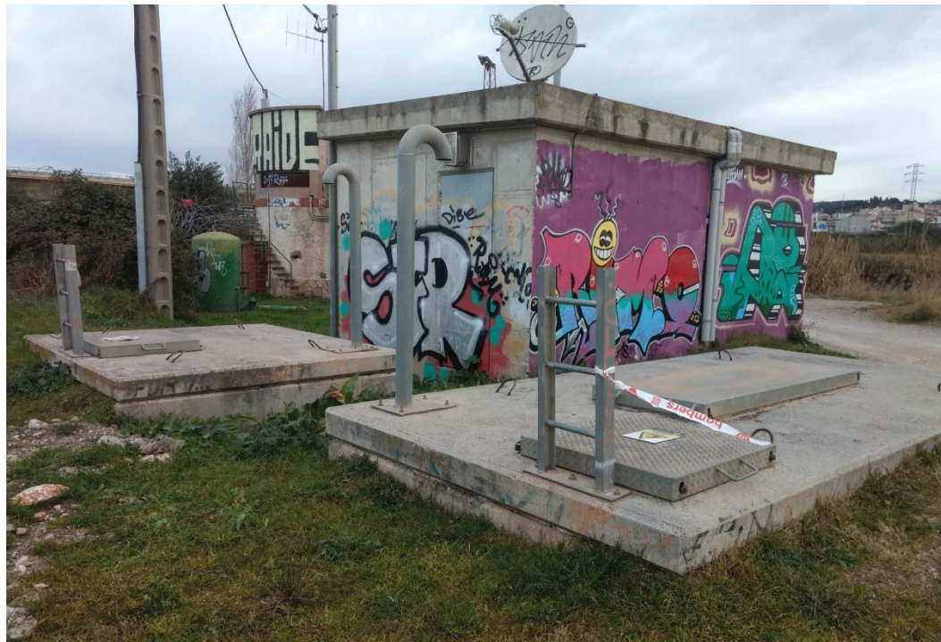
Fotografia 1: Arqueta de bombament (soterrada en primer terme) on arranca la canonada actual que abasteix els municipis de Cervelló i La Palma de Cervelló. Arqueta de maniobres (soterrada en segon terme) on s'inicia el tram de conducció de fosa dúctil DN400 definit al present projecte
