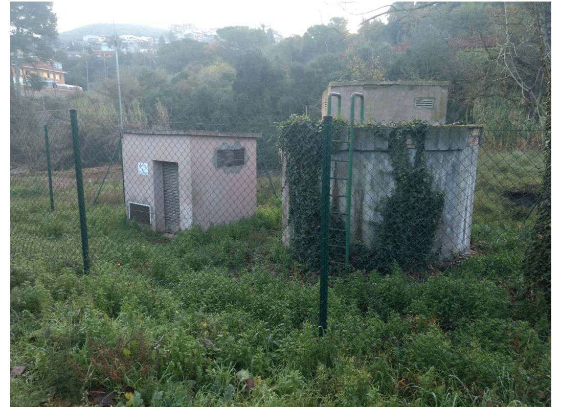
Fotografia 19: Instal·lacions annexes al dipòsit de Granja Garcia
