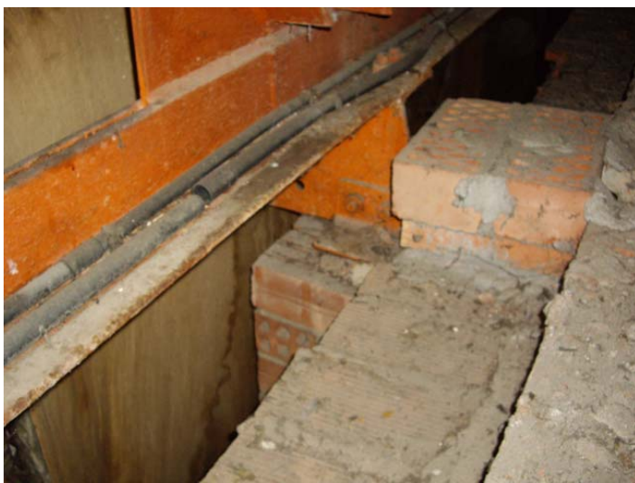
figura 6 – Unió sense recolzament entre pilar de rajol i gelosia.
