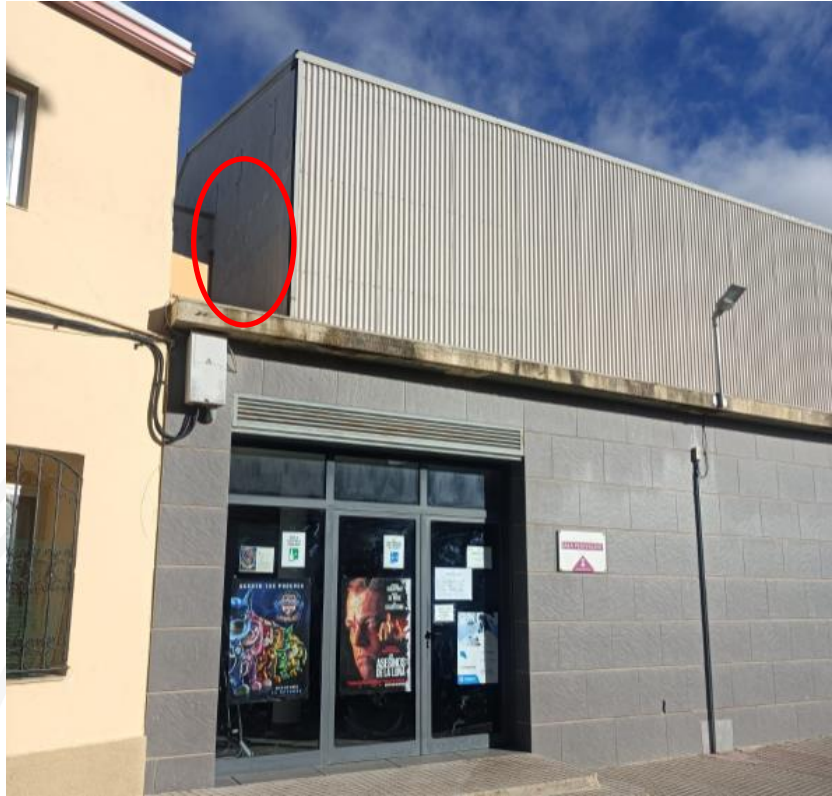
Imatge 9. Ubicació del'inversor i proteccions
