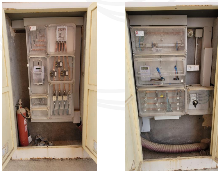
Imatge 4 i 5. Centralització de comptadors.
