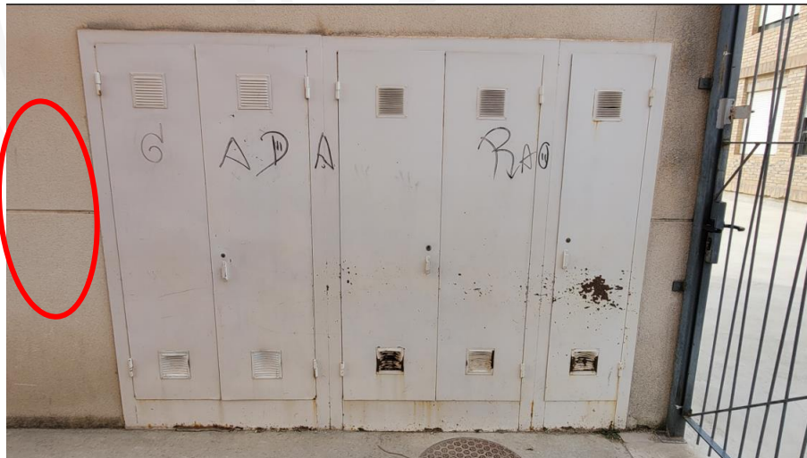
Imatge 15. Armari de comptadors i ubicació de la TMF-10 de generació.
