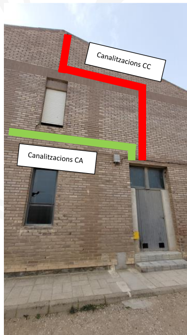
Imatge 13. Canalitzacions de cablejat
