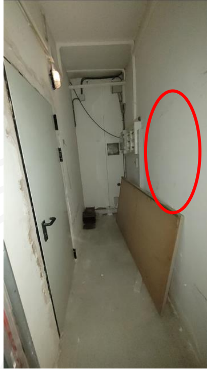
Imatge 12. Ubicació de l'inversor i proteccions
