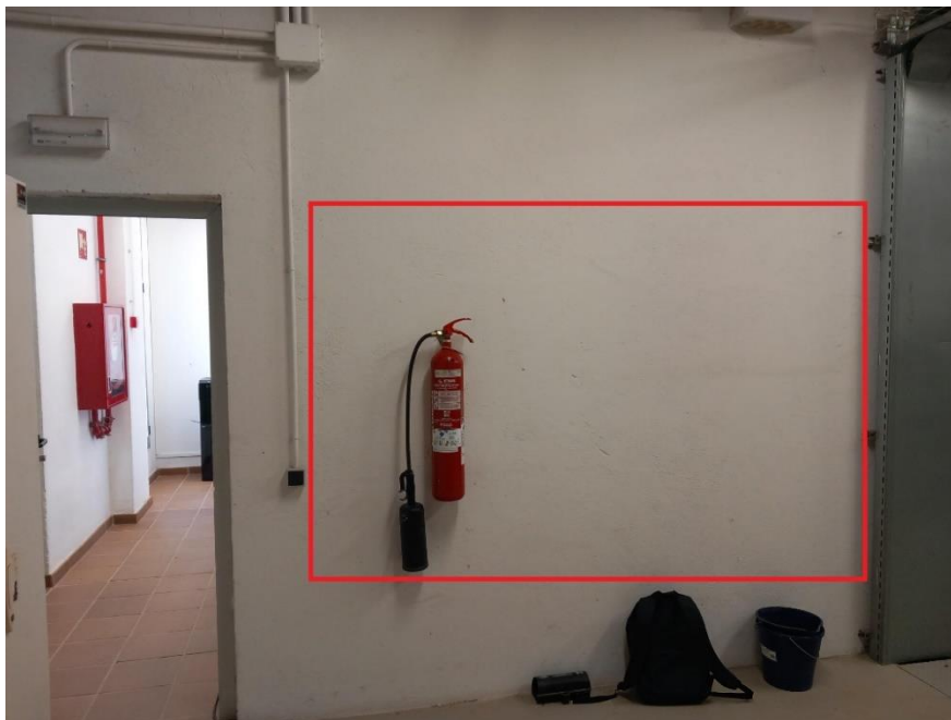
Figura 5 Ubicació inversors i quadres de proteccions
