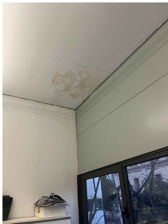
Fotografia 1. Filtracions a l'interior.
