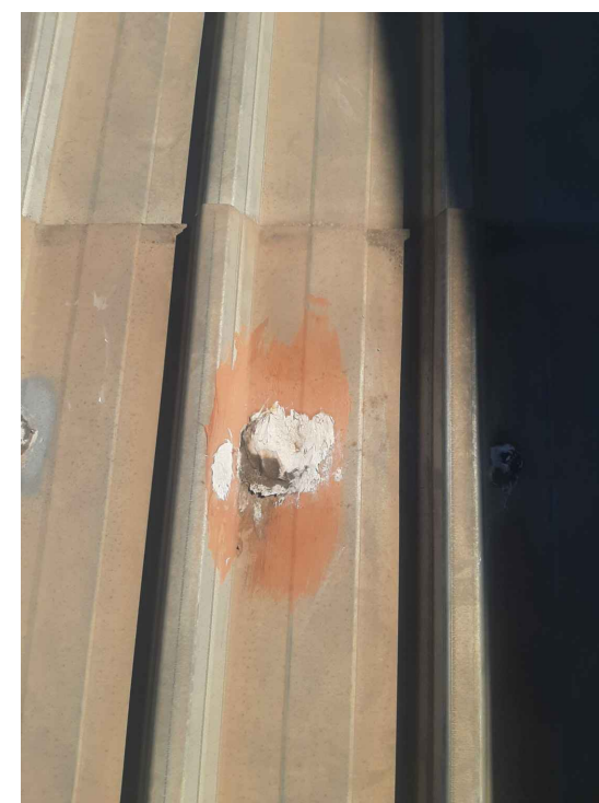
Fotografia 9. Cargol trenat a substituir.
