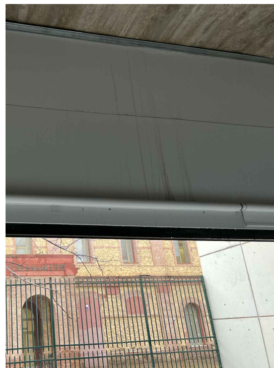
Fotografia 3. Filtracions a l'interior.
