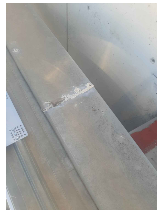
Fotografia 10. Junes de les xapes perimetrals a tractar.
