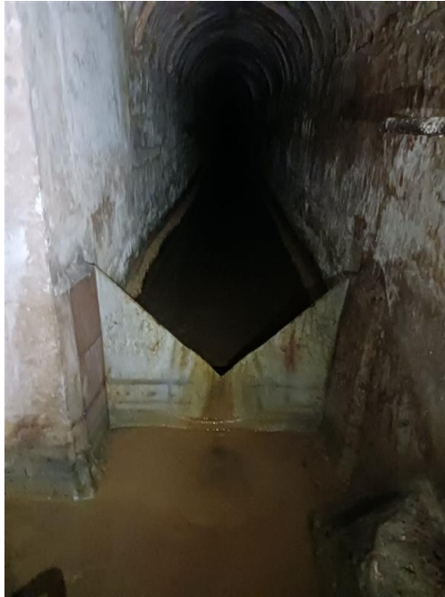
Estado actual vertedero de la galería de la mina
