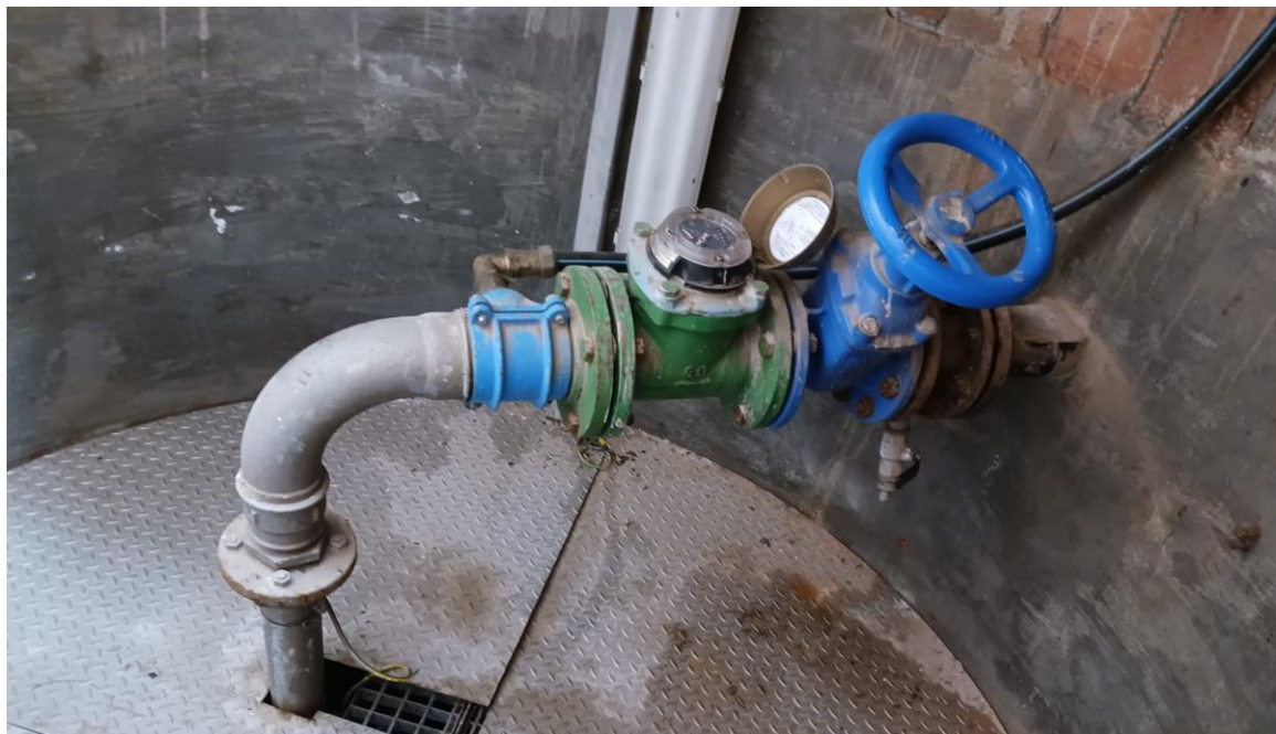
Estado actual pozo 11 / Caudalímetro DN80
