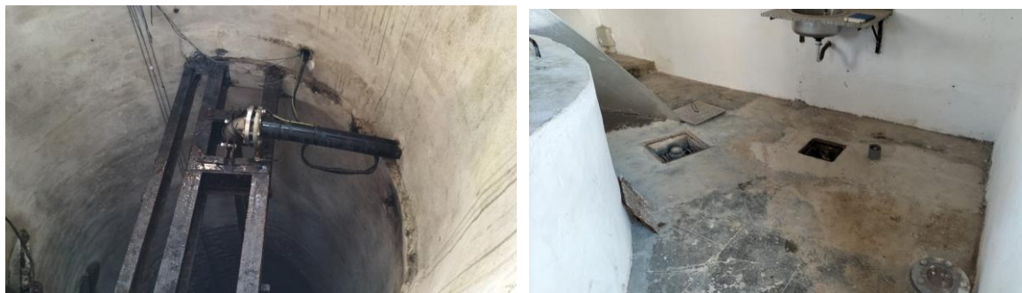
Estado actual interior caseta pozo 5 / Caudalímetro DN80
