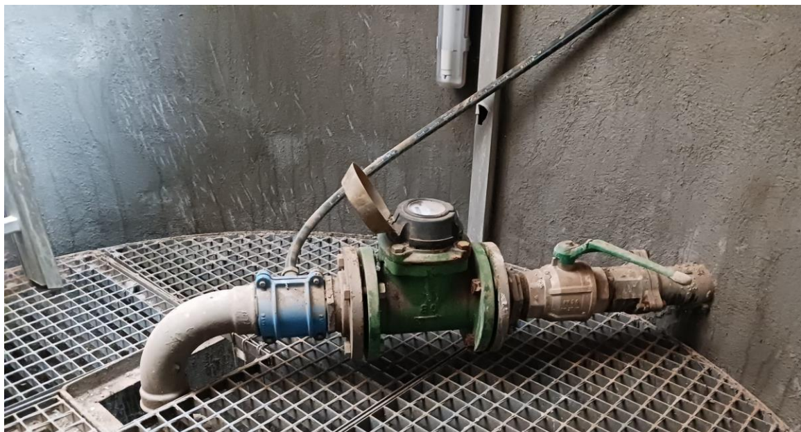
Estado actual pozo 12 / Caudalímetro DN80
