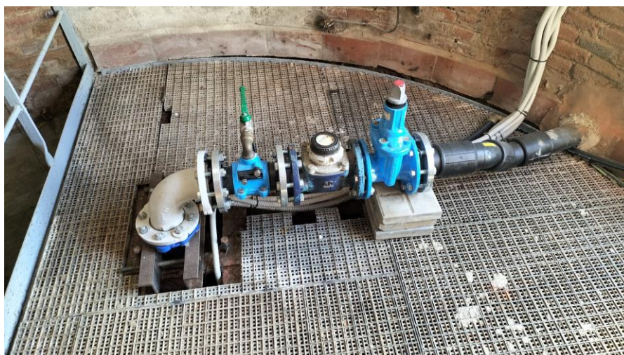
Estado actual pozo 4 / Caudalímetro DN80
