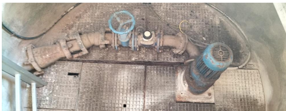
Estado actual pozo 8 / Caudalímetro DN100
