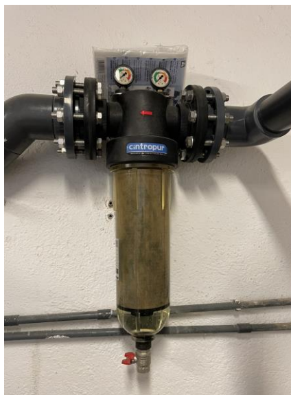
Imatge del filtre d'escomesa de l' edifici 1
