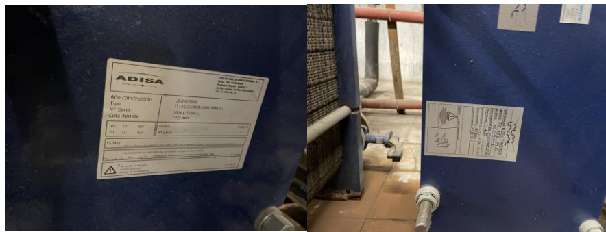
Imatges dels intercanviadors de plaques
