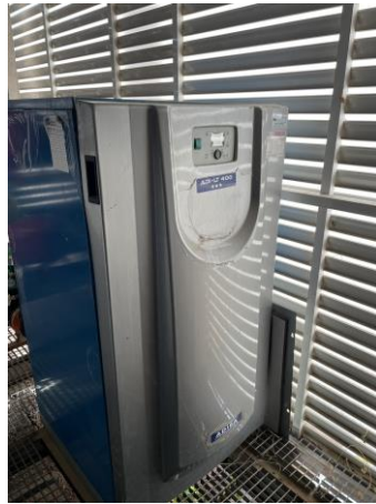
Imatge de la caldera de gas
