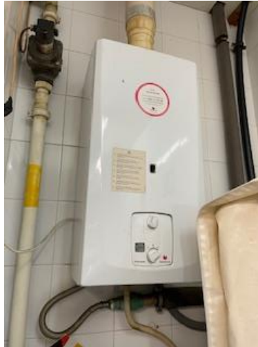
Imatge de la caldera de gas de la cafeteria Edifici 2
