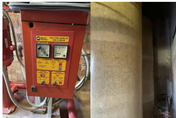
Imatge de la bomba i visió general dels 3 tancs del contraincendis
