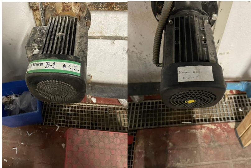
Imatge de les dues bombes de retorn i de la visió general del circuit i col·locació de les bombes
