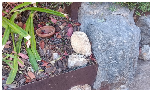
Pedres caigudes a la finca nº 2bis
