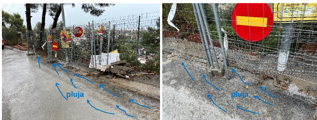
Figura 6: Infiltració d'aigua d'escorrentia des del vial del Pg. de la Muntanya 21 a través de l'esquerda.
