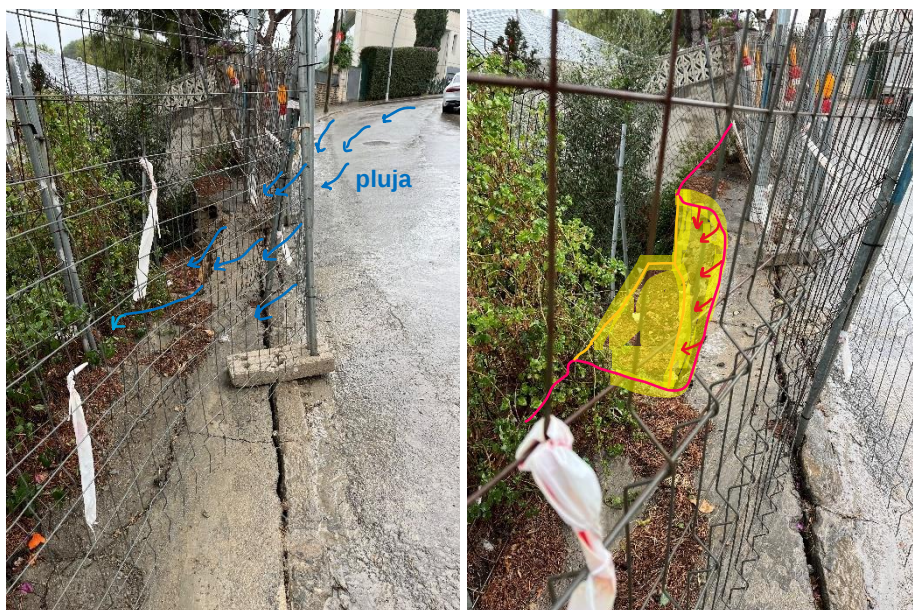
Figura 5: Aspecte de l'enfonsament i basculament del muret de la vorera del Pg. de la Muntanya 21.
