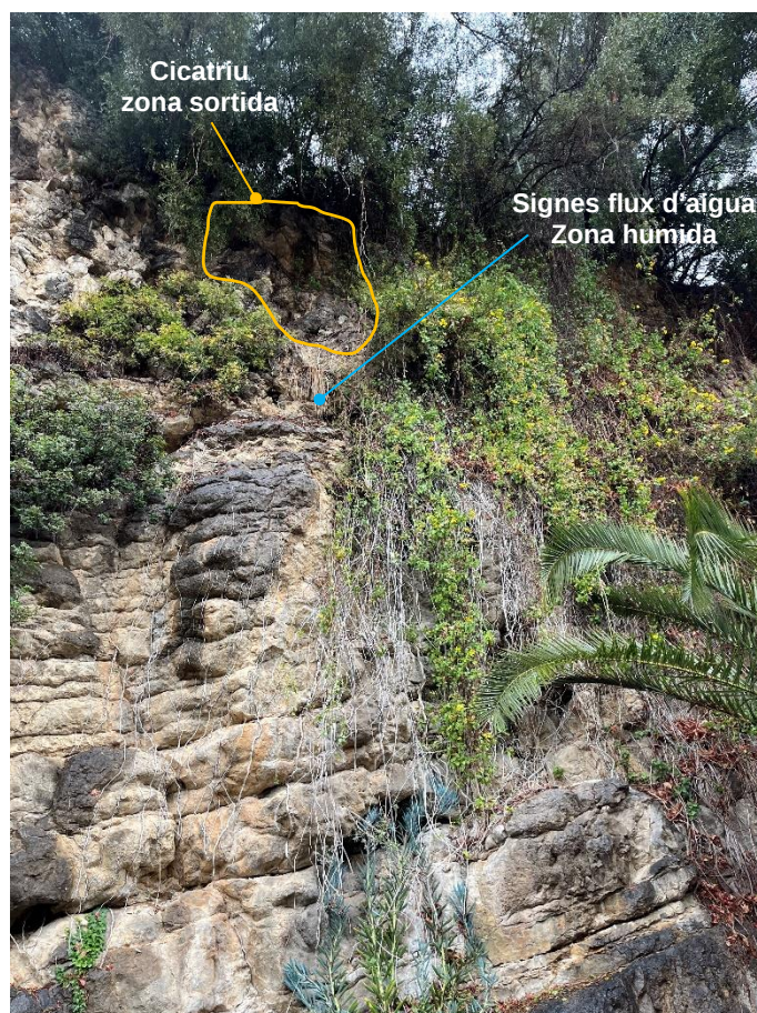
Figura 3: Aspecte del front del talús darrera l'habitatge núm. 2bis i identificació de la possible zona de sortida i humitats.
