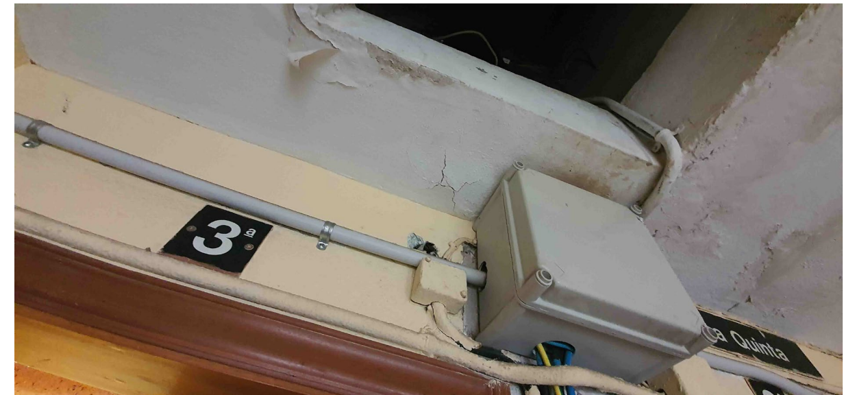
Imatge 12. Vista de caixa de derivació de instal·lació elèctrica de planta 3ª.
