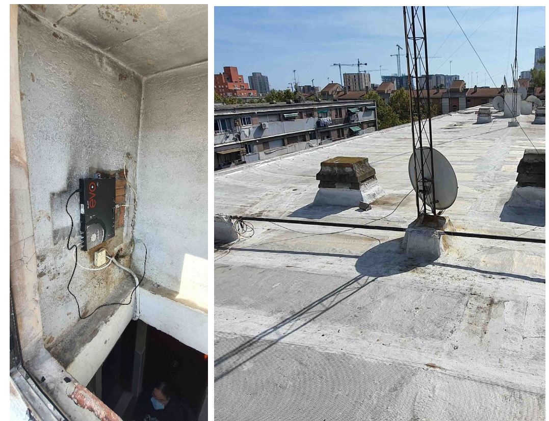
Imatges 18-19. Vistes de la instal·lació de telecomunicació existent.
