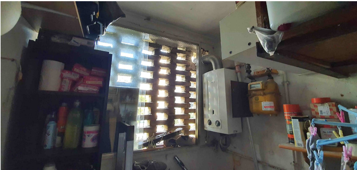
Imatge 21. Extracció de fums de caldera a façana.
