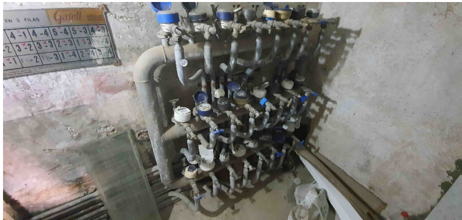
Imatge 14. Vista de bateria de comptadors d'aigua.
