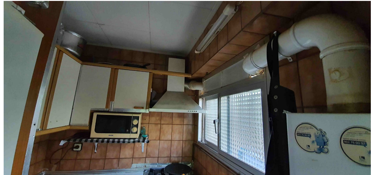
Imatge 22. Ventilació de campana extractora i caldera a façana.
