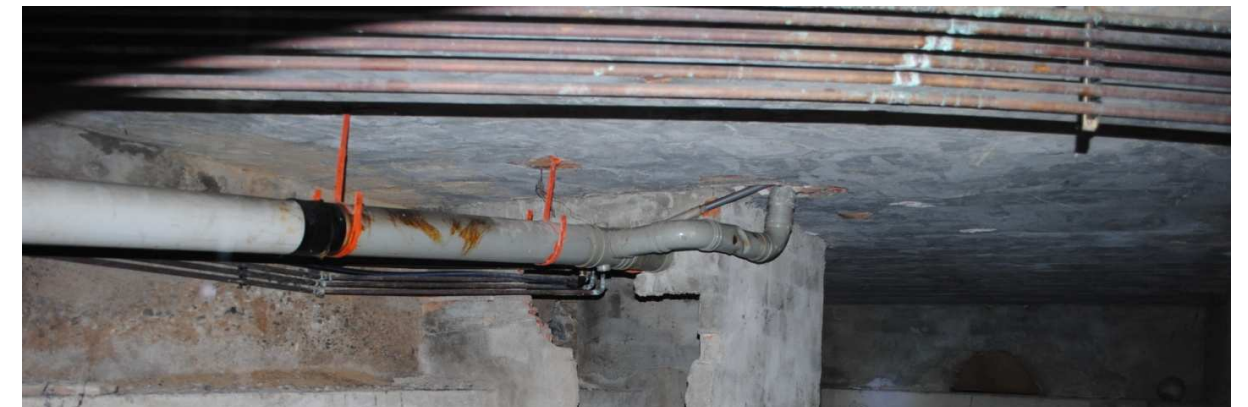
Imatge 13. Col·lectors de sanejament a cambra sanitària.
