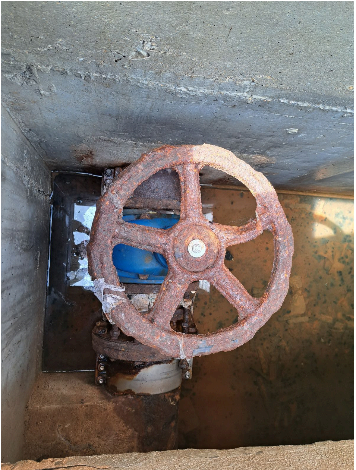
Foto Núm 3: Estat actual del col·lector i connexió amb la part soterrada.
