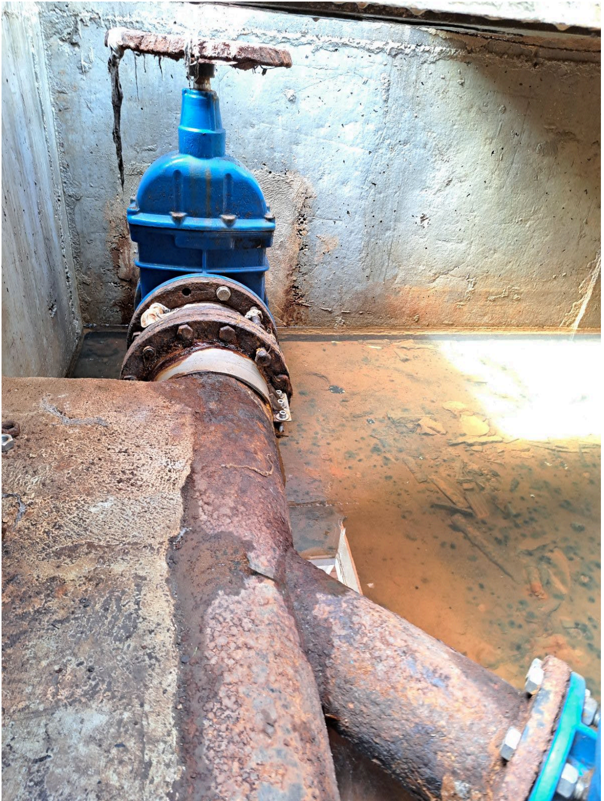
Figura núm 2. Estat actual del col·lector de l'EB la Mora.
