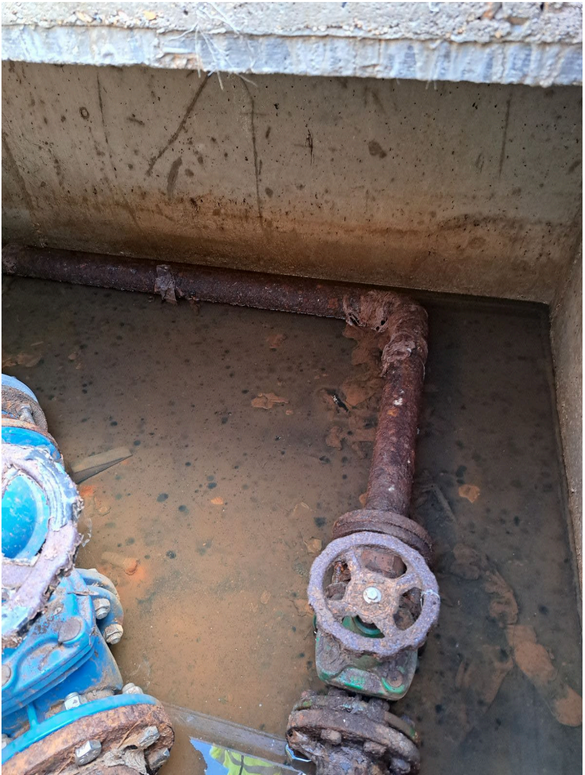
Foto Núm 6: Estat actual del ramal DN80 del col·lector.
