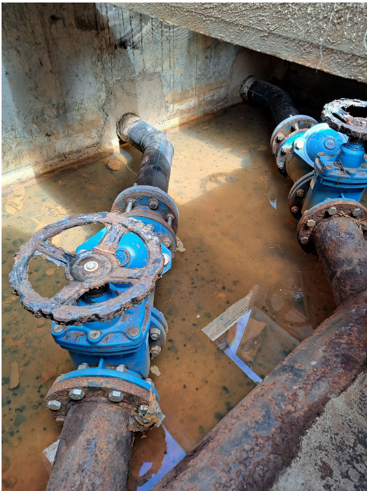
Figura núm 3. Estat actual del col·lector de l'EB la Mora.
