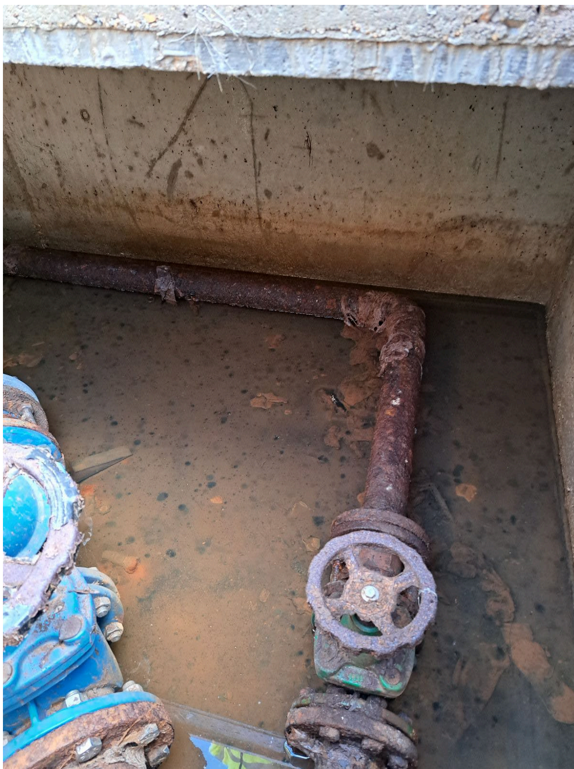
Figura núm 4. Estat actual del col·lector de l'EB la Mora.
