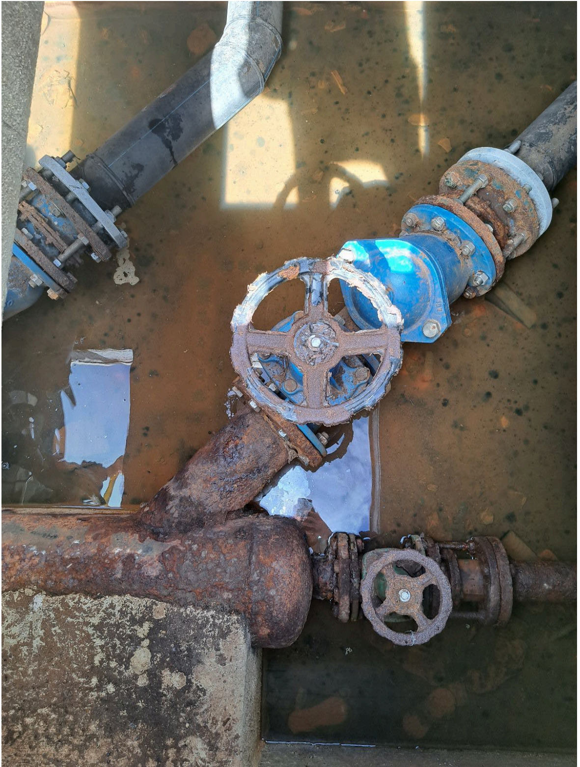
Figura núm 5. Estat actual del col·lector de l'EB la Mora.
