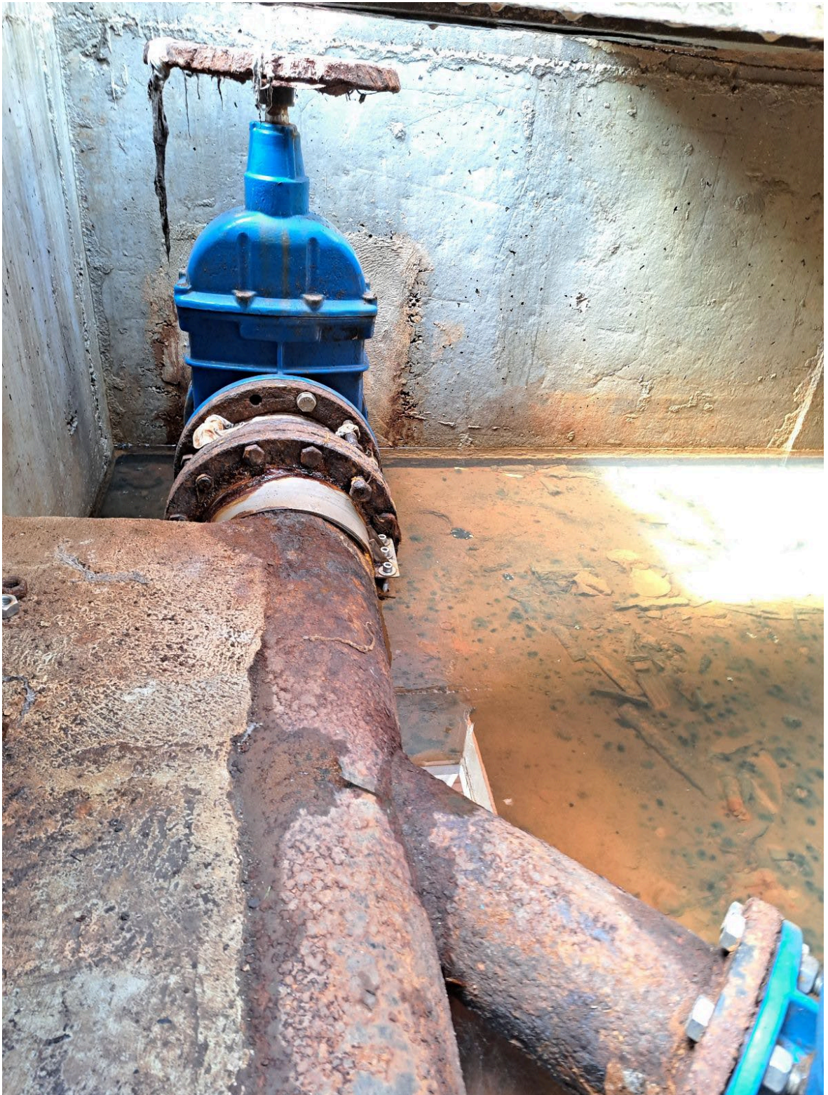
Foto Núm 4: Estat actual del col·lector, ramal principal de DN 250
