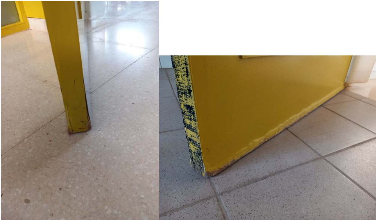
Fotografia 5 i 6: Estat de les portes
