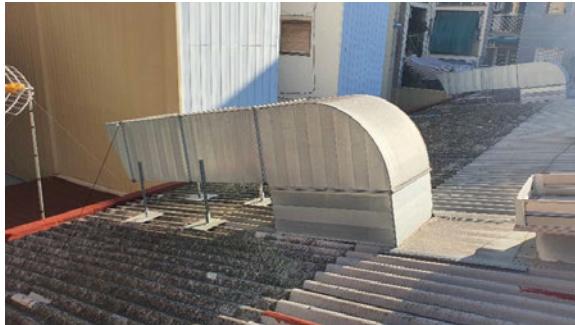
Sortida conductes de ventilació a coberta
