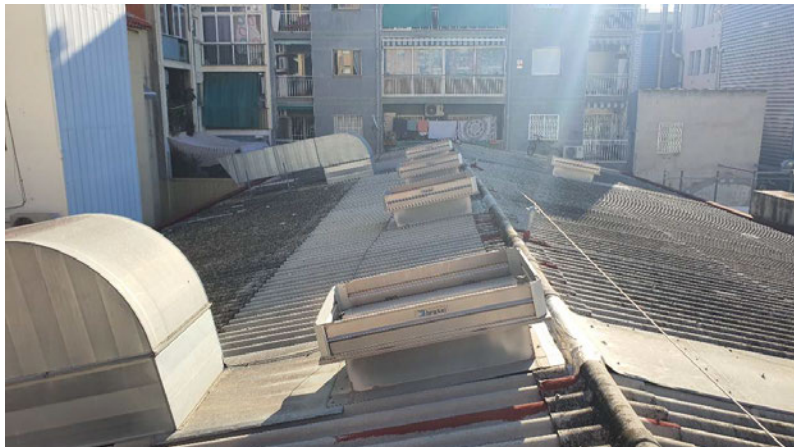
Coberta de fibrociment a substituir
