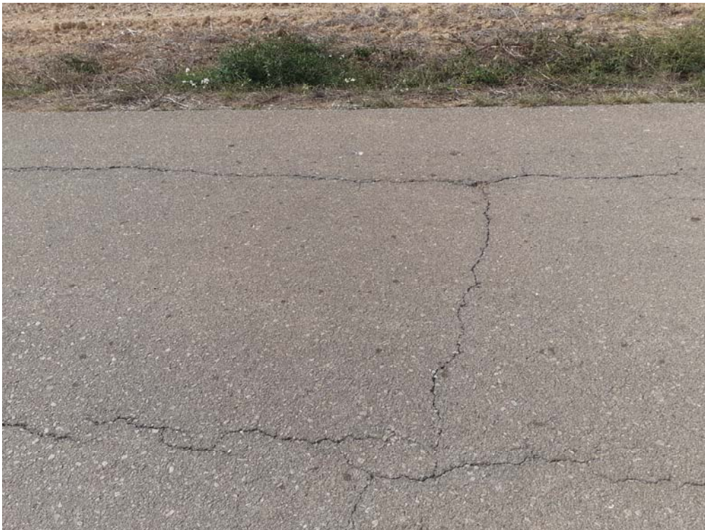
X: 500610, Y: 4671158. Paviment en mal estat
