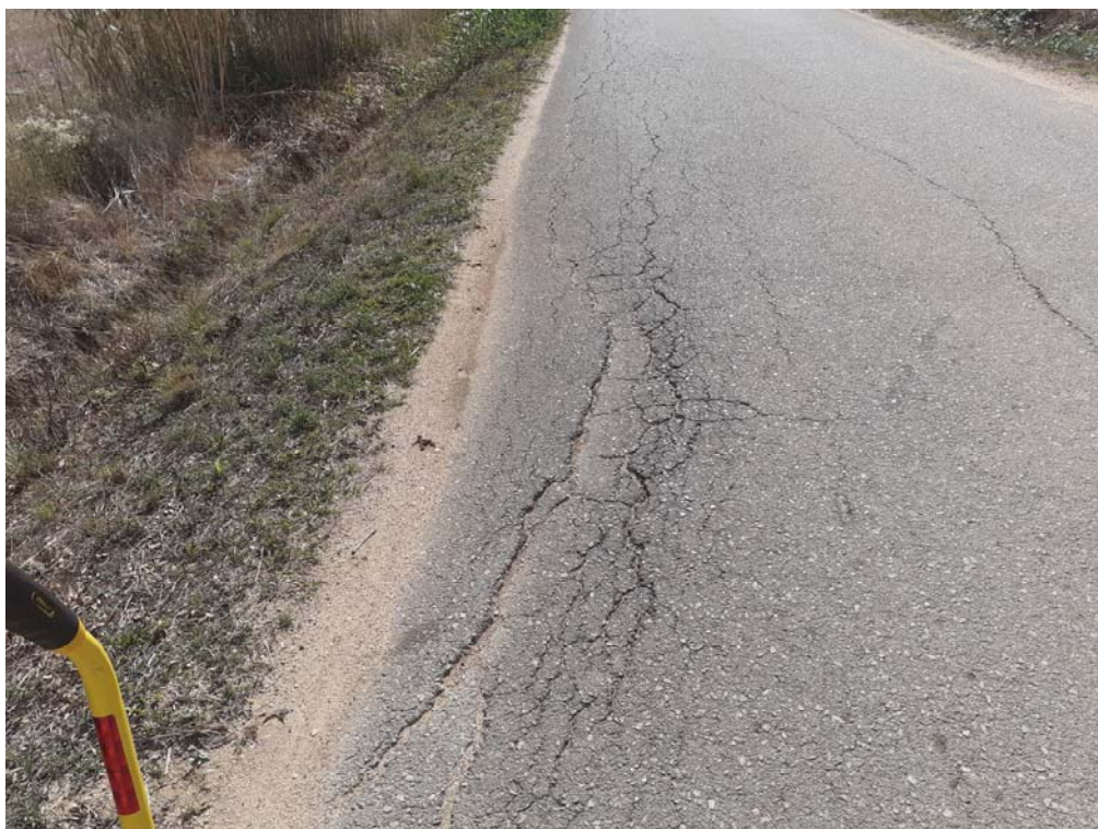
X: 500563, Y: 4671234. Paviment en mal estat
