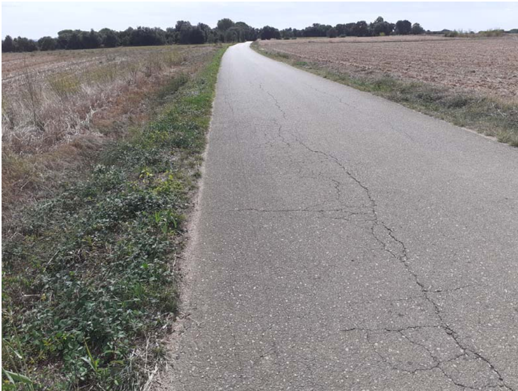
X: 500610, Y: 4671158. Paviment en mal estat
