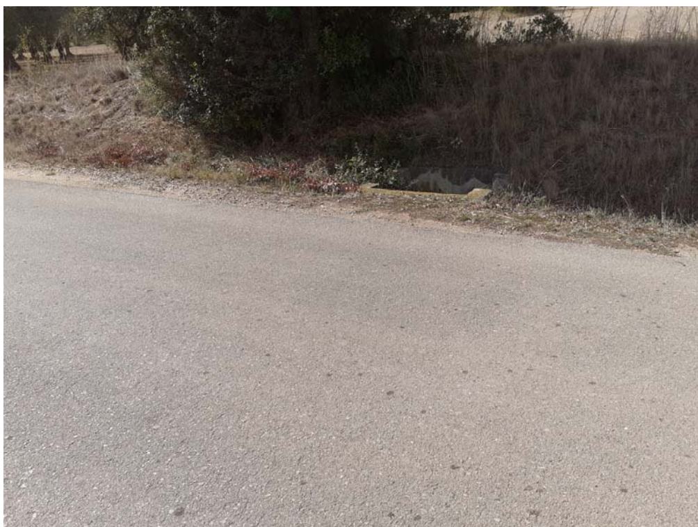
X: 500523, Y: 4671304 Pou de pluvials a tocar de la calçada.
