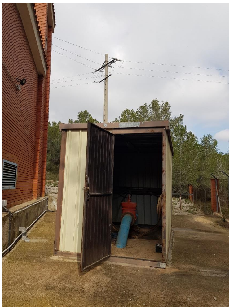
Imatge 6 Caseta pou II amb vàlvula existent
