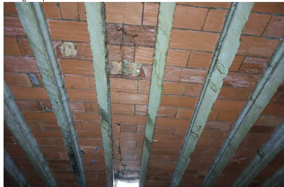
23. Trencament i fissuració del taulell de coberta
