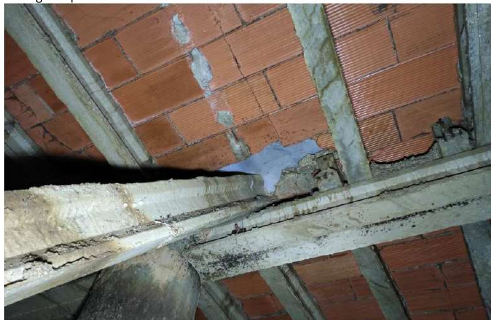
22. Trencament de taulell per caiguda de la bigueta de repartiment
