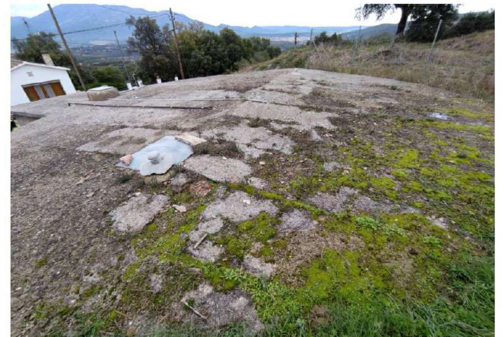
32. Fissuració i esquerdat de la coberta
