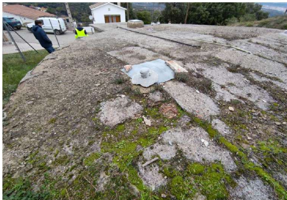
30. Degradació de la capa de compressió
