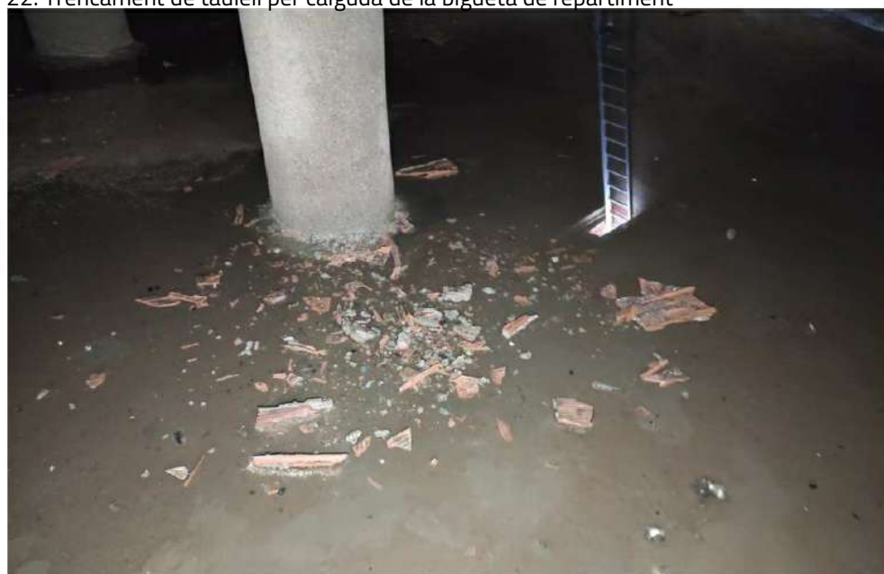
25. Restes de runa procedents de la degradació de les biguetes de repartiment
