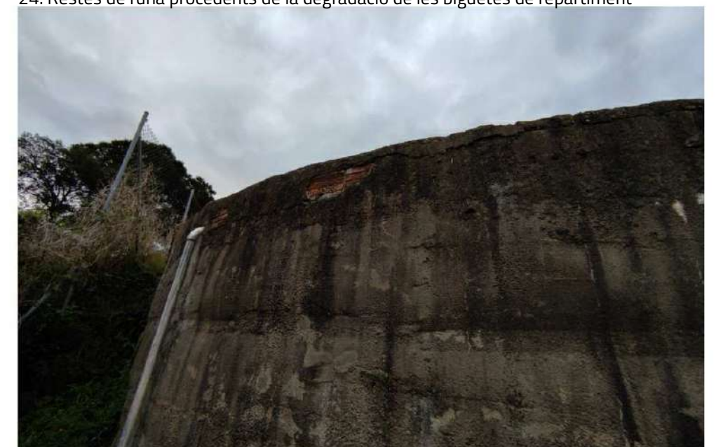
27. Degradació del revestiment exterior
