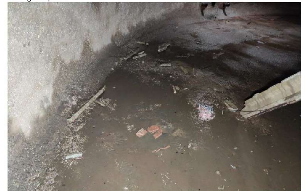
24. Restes de runa procedents de la degradació de les biguetes de repartiment
