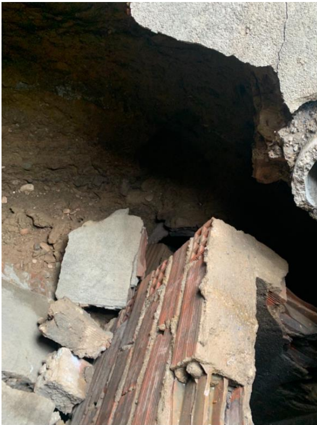
Foto 3. Cos del pou derruït i cavitat
