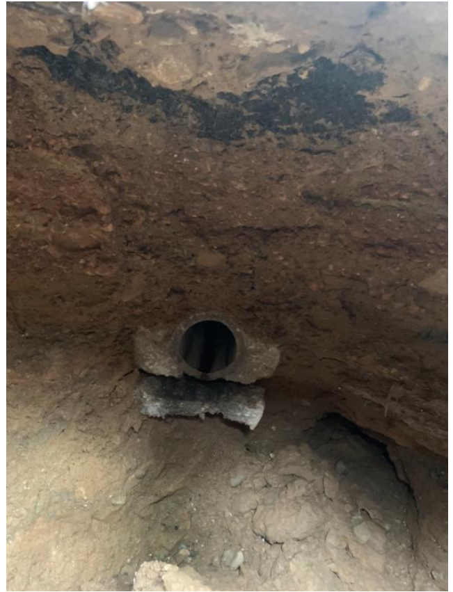
Foto 2. Connexió embornat deconnectat del pou
