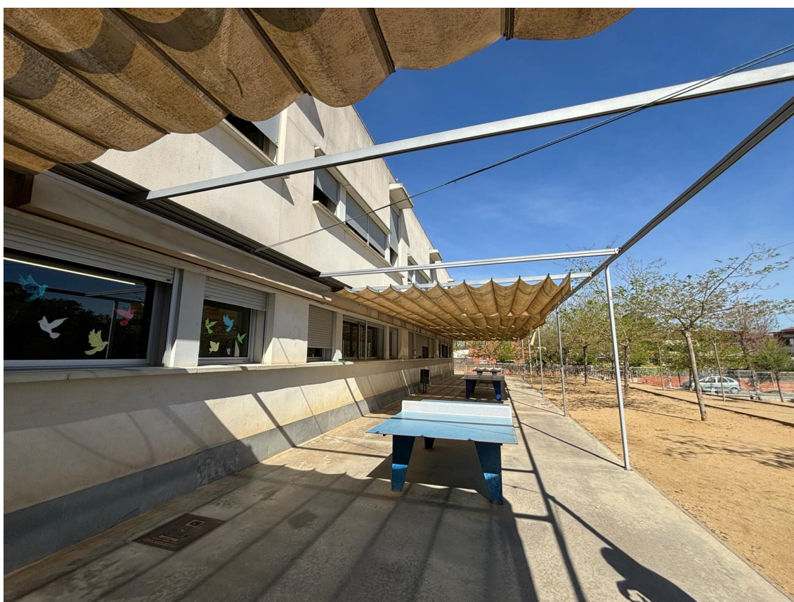
Tendals de tipus onda existents i on s'ha de canviar el teixit i fer un repàs de manteniment i bon funcionament dels mecanismes.
