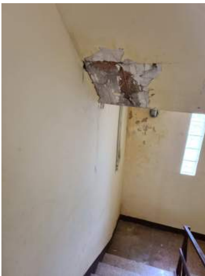
Filtracions d'aigua en coberta plana a les escales
