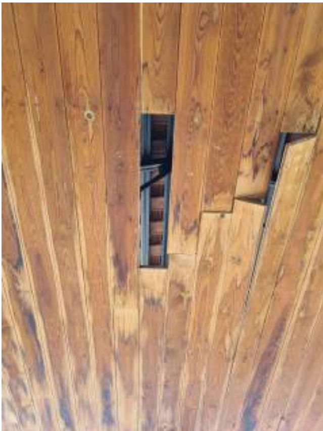
detall de fals sostre amb forat on s'observa la teula de la coberta sense aïllament
