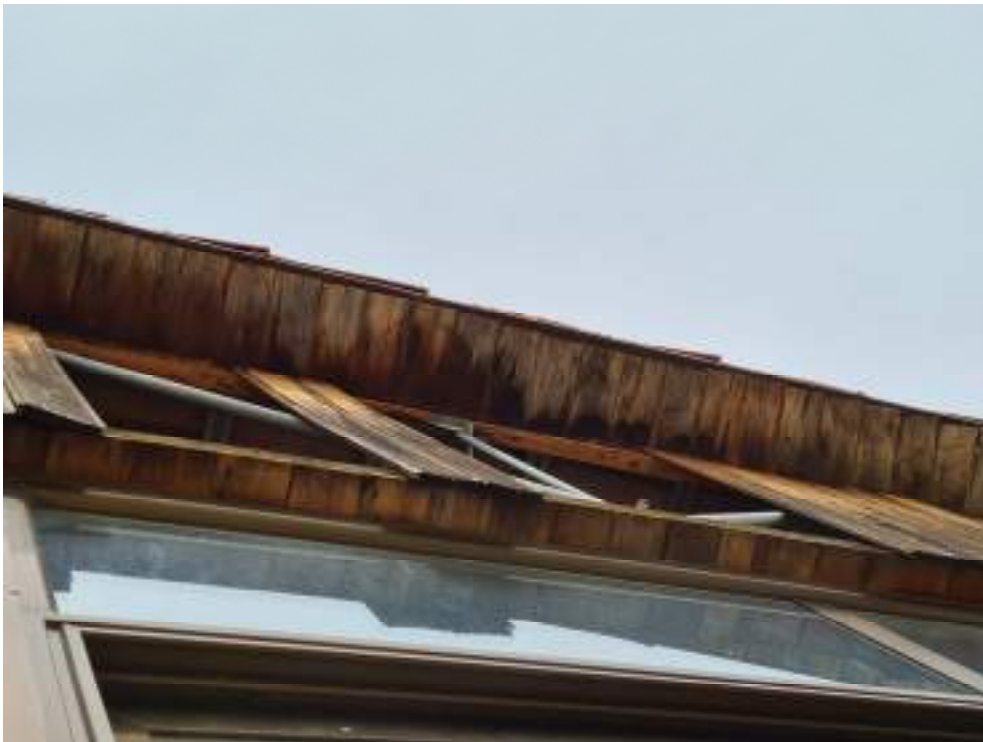
detall del voladís de la coberta inclinada amb recobriment de fusta malmès
