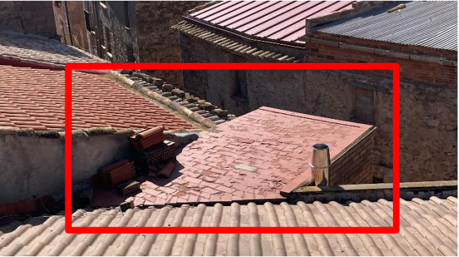
Imatge 14 : Coberta plana a reparar.
