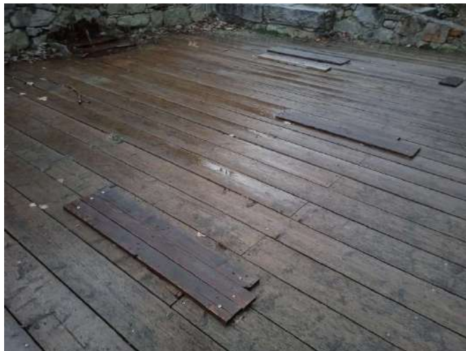
Imatge 4. Punts de tarima de fusta a reparar.
